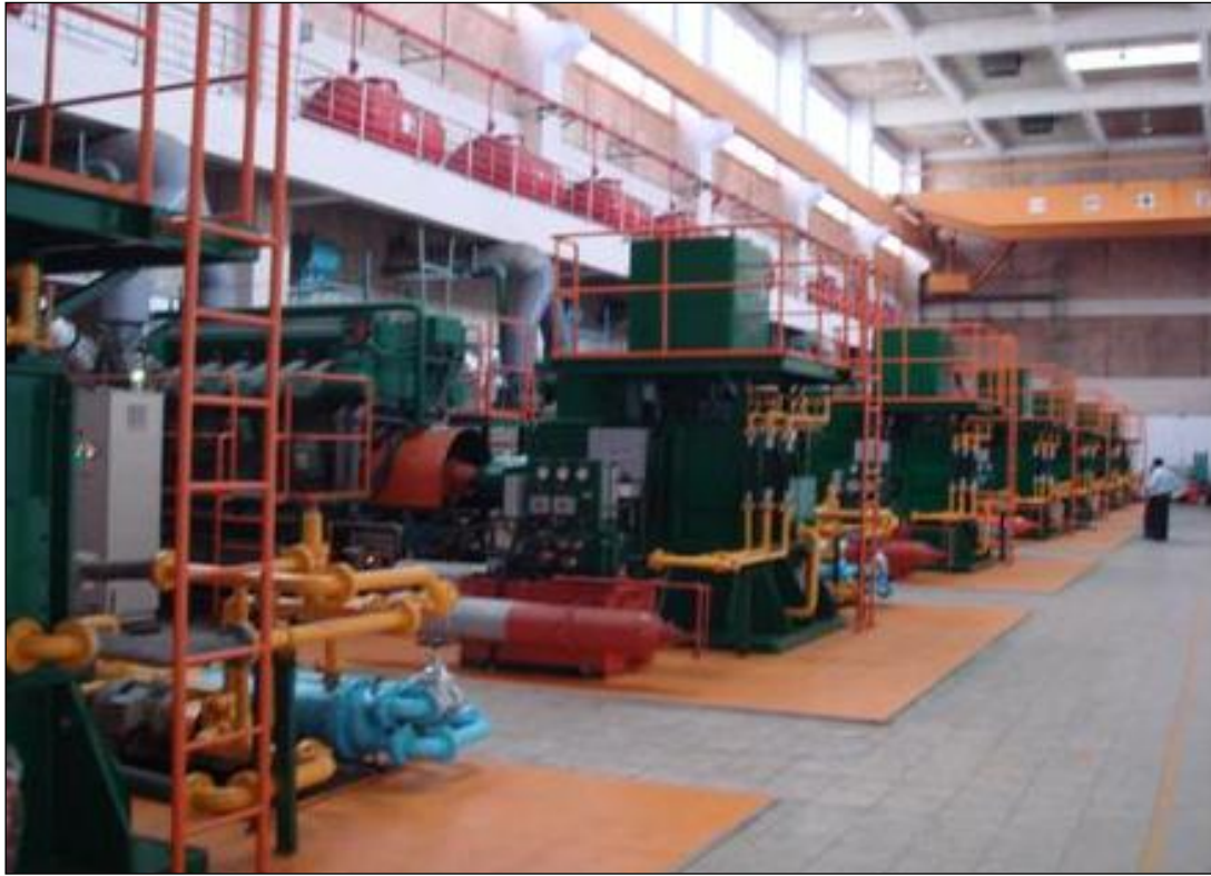
圖 9 抽水機組配置現況
