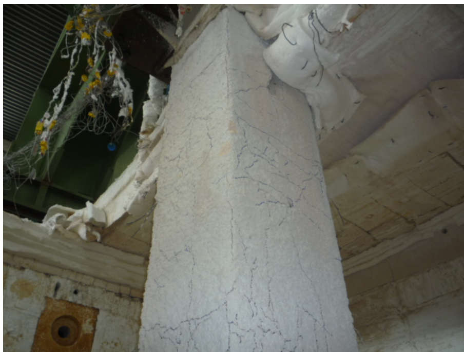
圖 4-13 試體 CFBC-1 上段試驗後防火被覆裂縫
