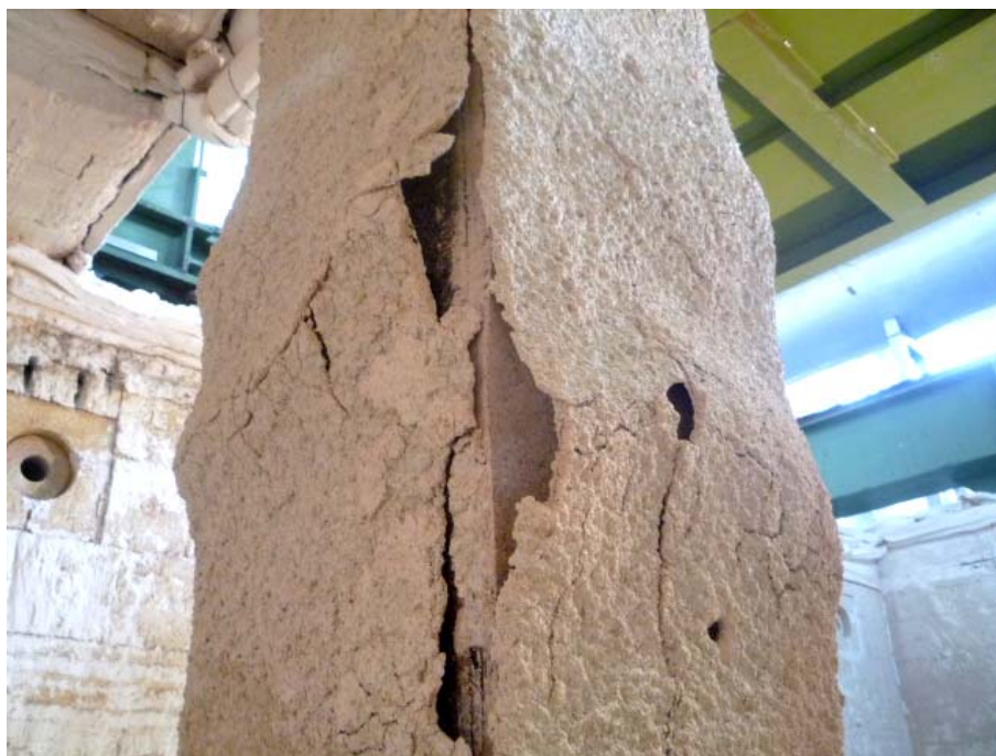
圖 4-29 試體 CFBC-2 中段試驗後防火被覆開裂
