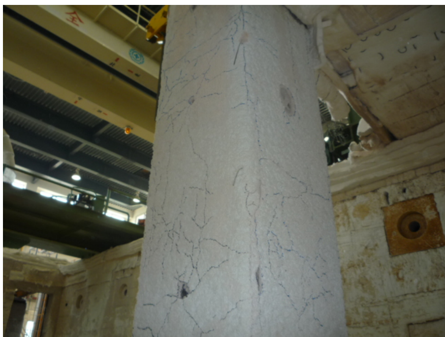
圖 4-14 試體 CFBC-1 中段試驗後防火被覆裂縫
