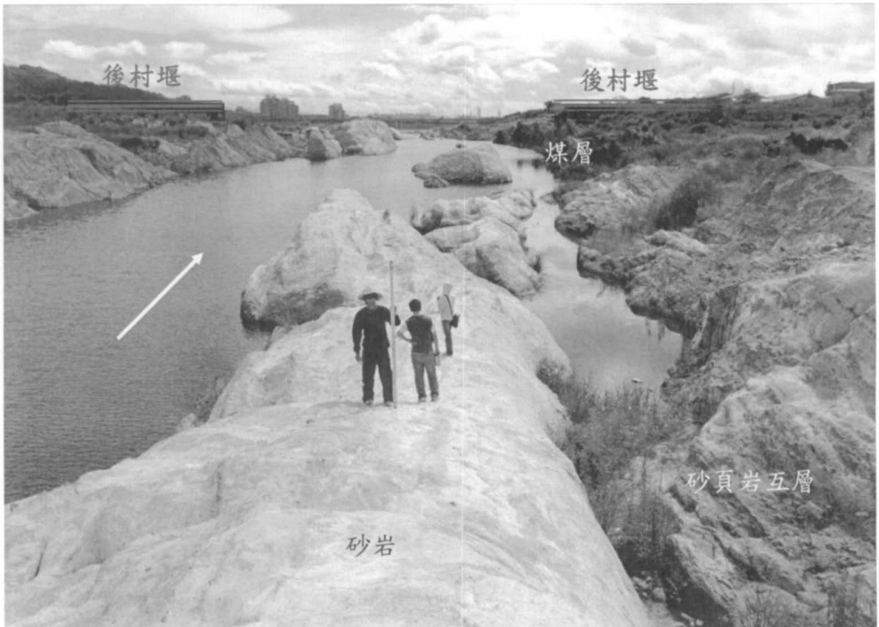
圖 5-2 後村堰現地沖蝕狀況照片
