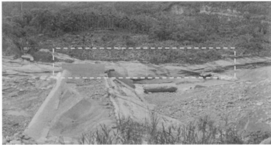
(b) 98.08.21 左岸混凝土牆沖毀，切穿出新河道
