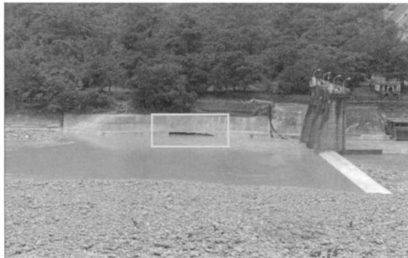
(b) 98.08.22 右岸護岸局部破損
