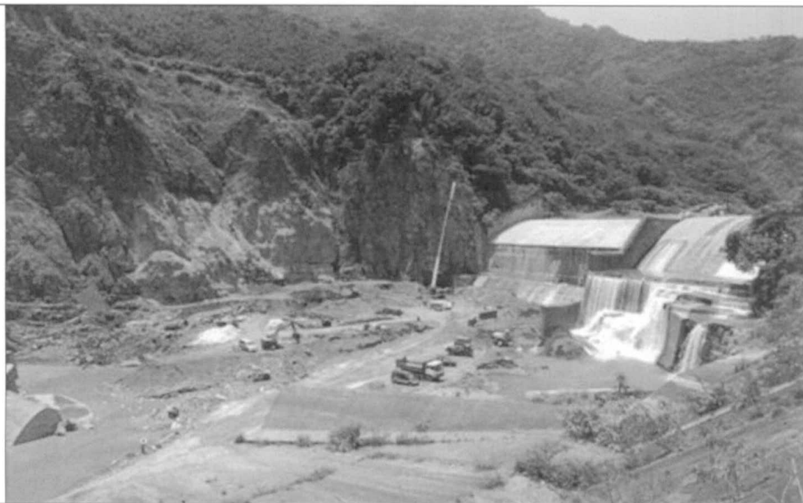
(b) 99.06.01 莫拉克風災未對北部照成重大差害，經歷民國 98 年汛期過後，義興壩進行修復工程，冲刷坑回填土石覆蓋。
