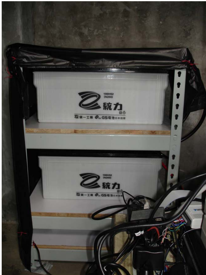
圖 2.9 高供電量(4800W)不斷電系統
