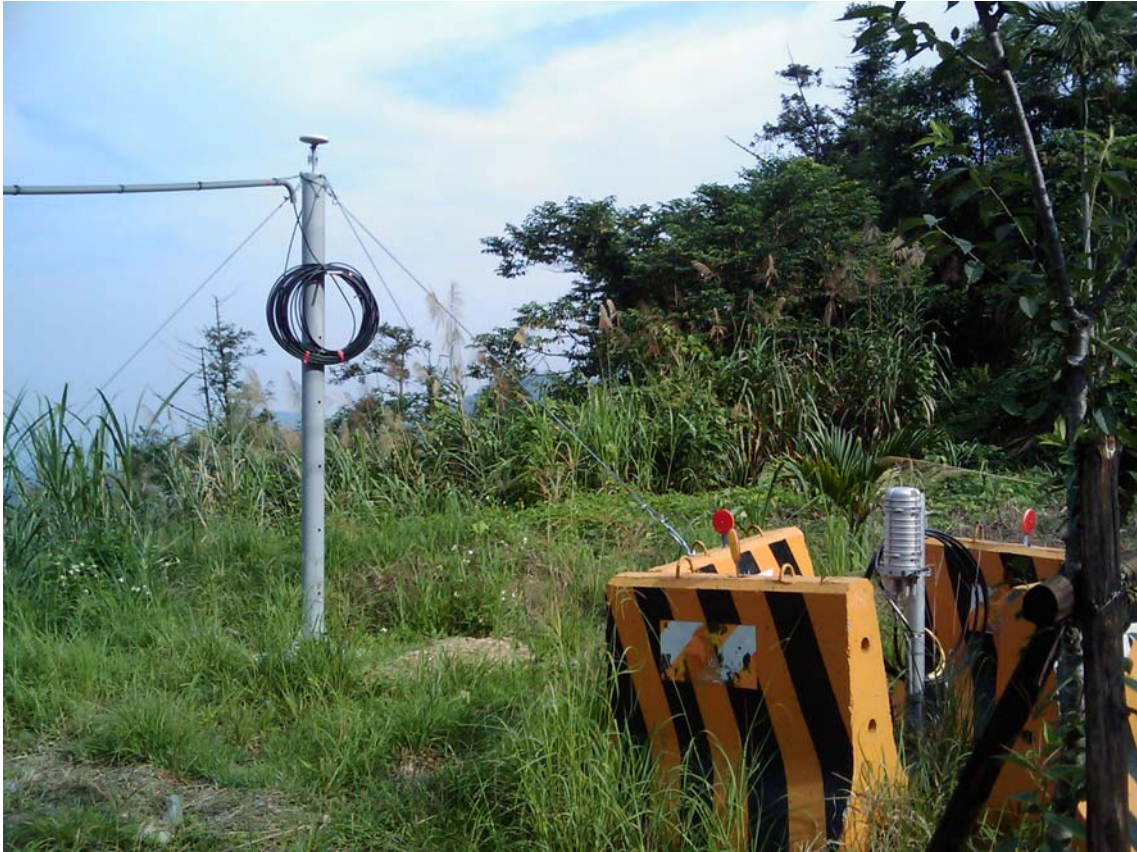
圖 2.4 IHMT-01 監測孔位旁之 GPS 監測站
