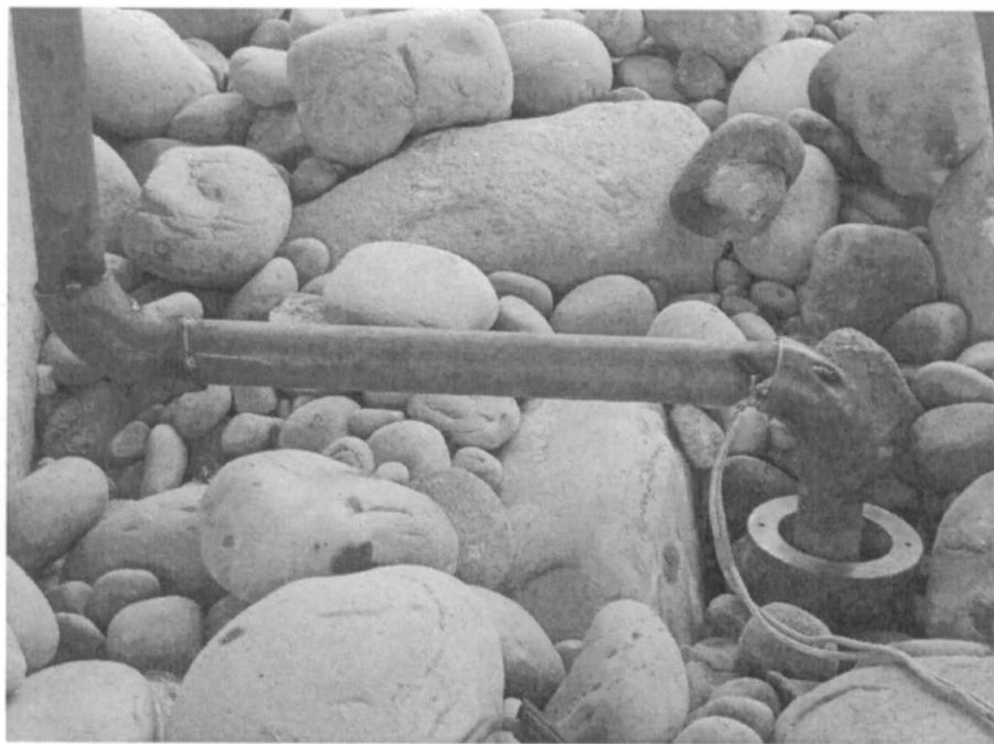
圖 3.14 地面光纖線路保護鋼管
