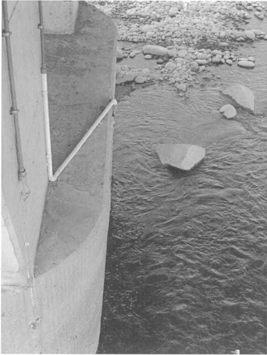
圖 4.39 現場損壞勘查
