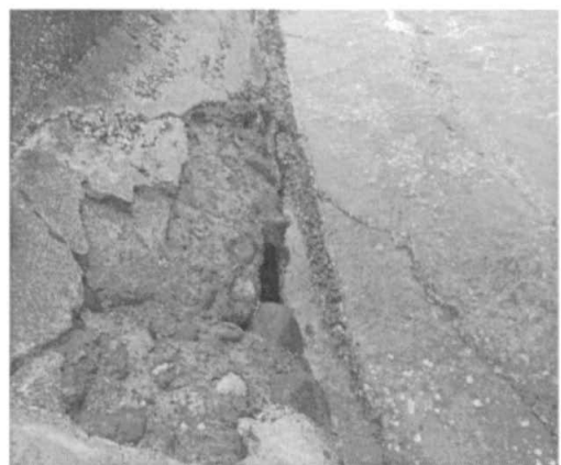
圖 4.66 花蓮港破損堤身
