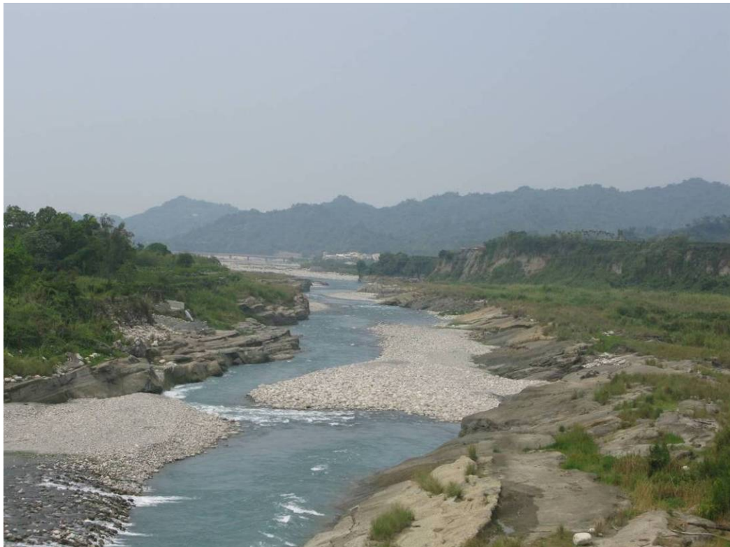
圖 16 大甲溪梅子鐵橋河道沖蝕狀況
