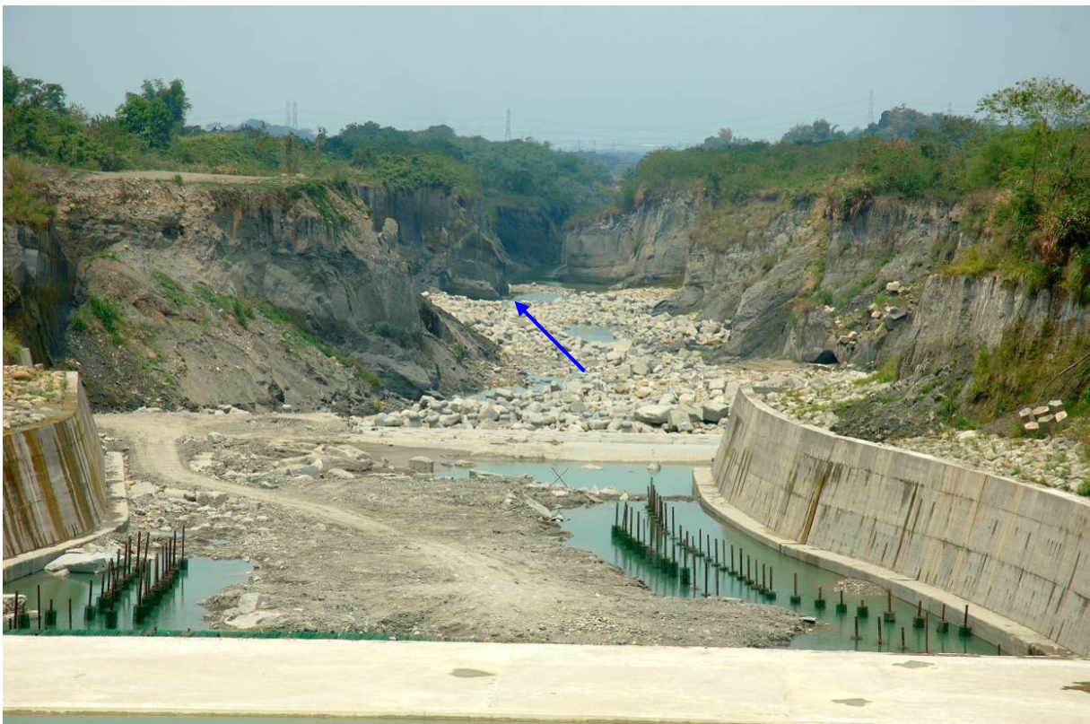
圖 25 八掌溪仁義潭攔河堰下游河道下切狀況
