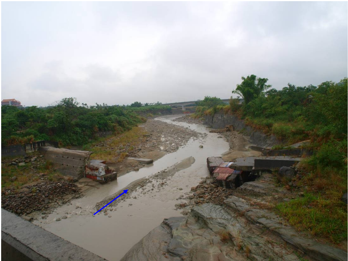
圖 24 八掌溪五虎寮橋下游河道侵蝕狀況
