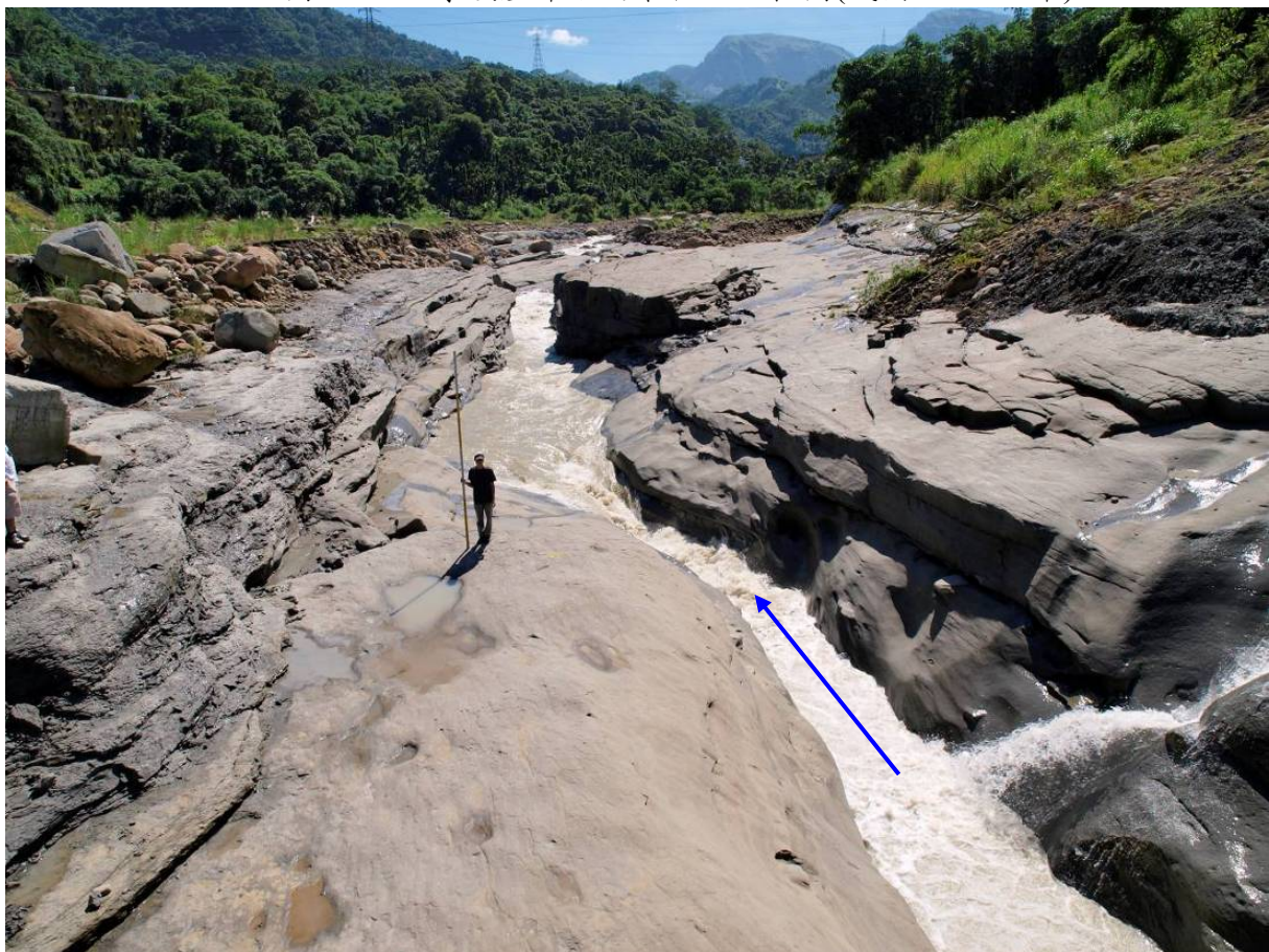
圖 23 八掌溪觸口堰河道侵蝕狀況
