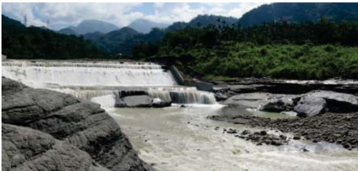
圖 3- 40 觸口攔河堰靜水池前局部沖刷狀況(97.10.18)
