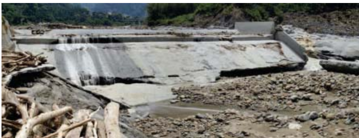
圖 3- 41 觸口攔河堰靜水池前局部沖刷狀況(98.8.21)
