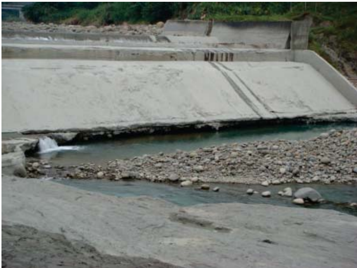
圖 3-39 觸口攔河堰靜水池前局部沖刷狀況(96.11.4)
