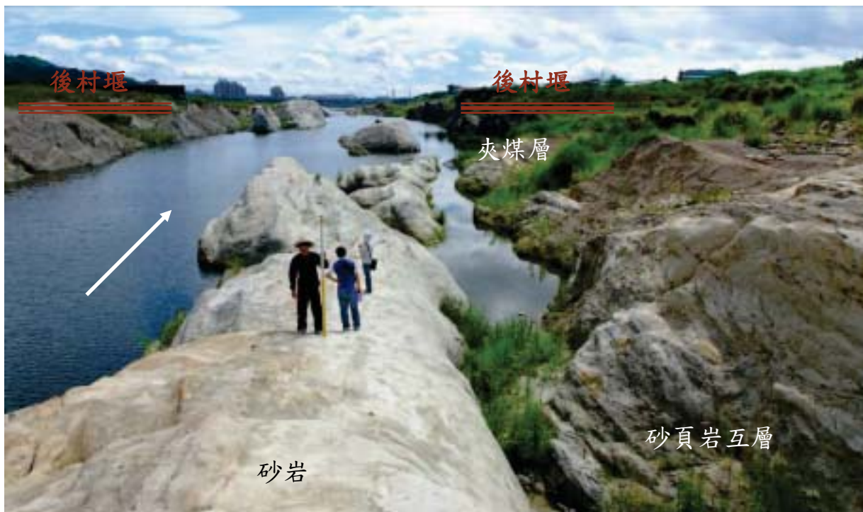
圖 5-5 後村堰沖蝕狀況
