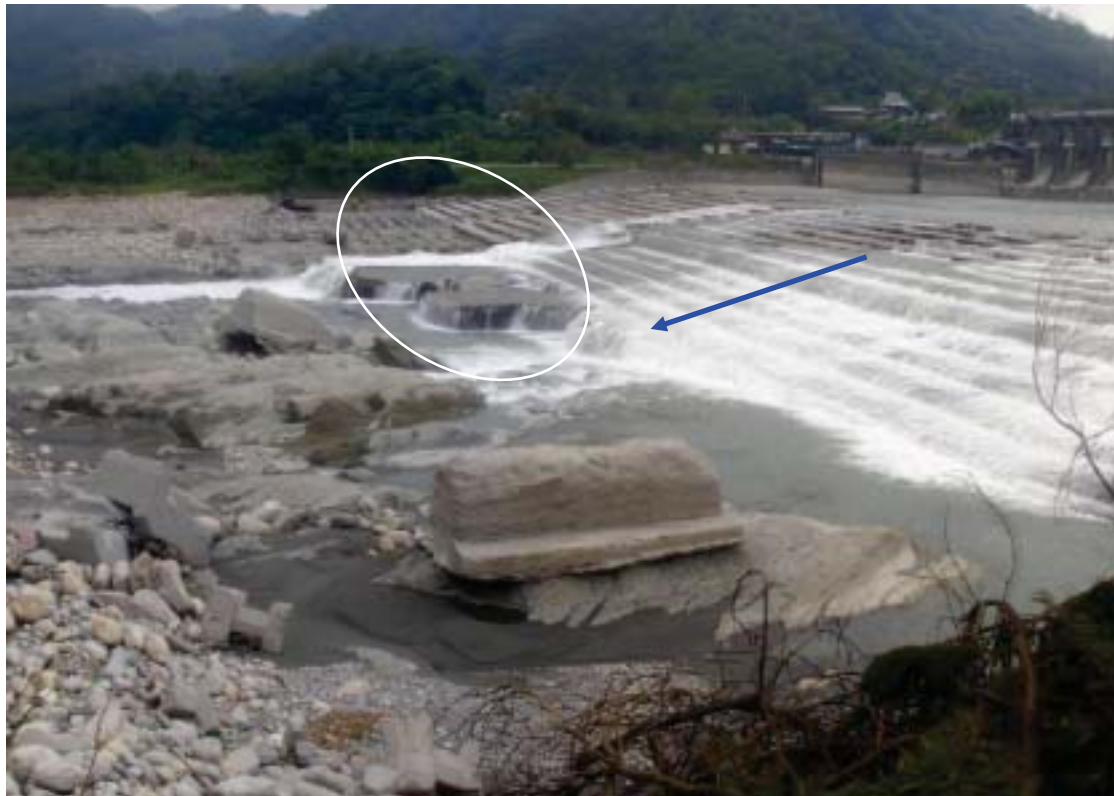
圖 3-17 石岡壩跌水工基礎前方沖刷坑(226448, 2686040, N, 980827)
