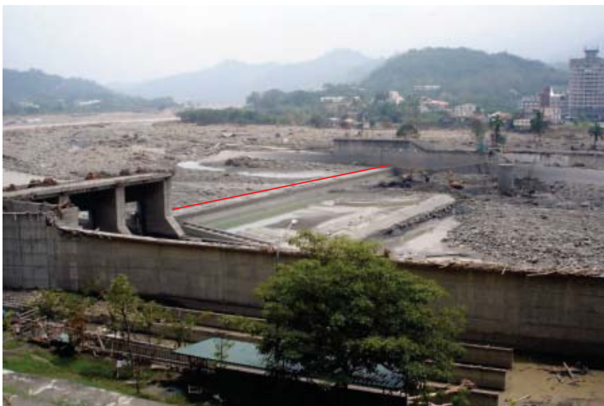
(b) 莫拉克颱風後護坦被沖毀，靜水池基礎下方岩盤暴露形成沖刷坑(98.8.22)
