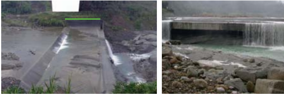
圖 3-38 觸口攔河堰靜水池前局部沖刷狀況(94.4.13)
