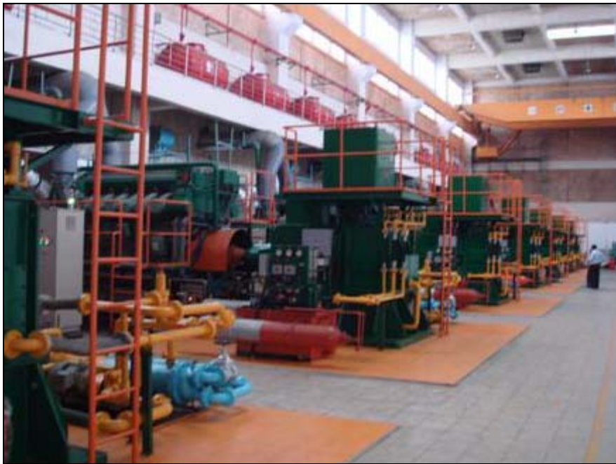
圖8 抽水機組配置現況
