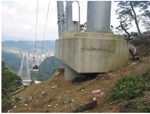
二〇〇八年，蕃蜜颱風重創北部文山區， 貓空纜車塔柱掏空面積擴大、附近地表鬆動，造成更嚴重的土石流， 纜車建設對於當地的安全造成衝擊。（圖片來源／簡余晏部落格）
