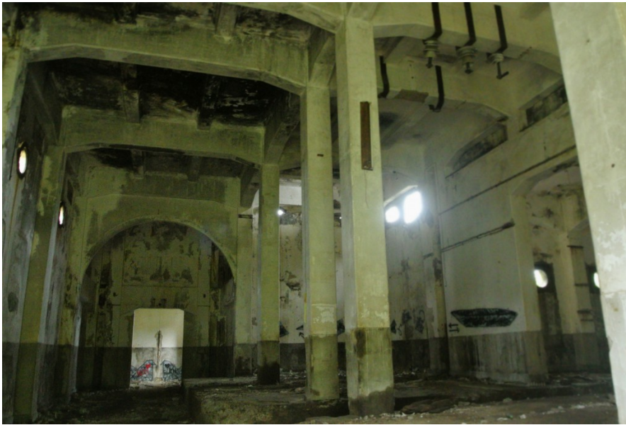
廢棄的廠房內，牆壁與梁柱滿是鏽蝕，還有不知哪來的塗鴉客，鮮豔的圖畫卻掩不住歲月的寂寥。（照片來源／黃吏玄攝）
