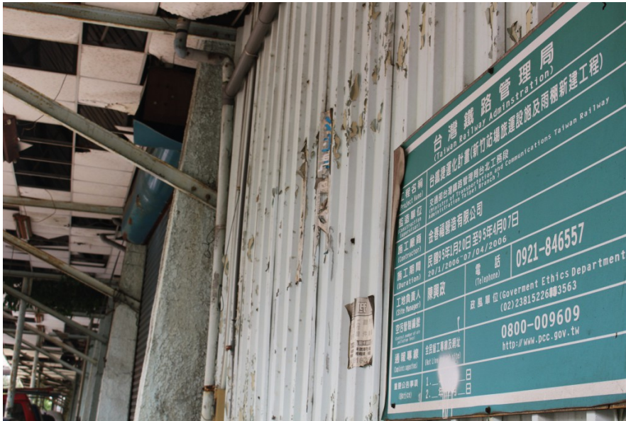
原本預定為台鐵捷運化的旅運設施工程，淪落為荒廢的鐵皮屋。(照片來源/曾婕茵攝)
