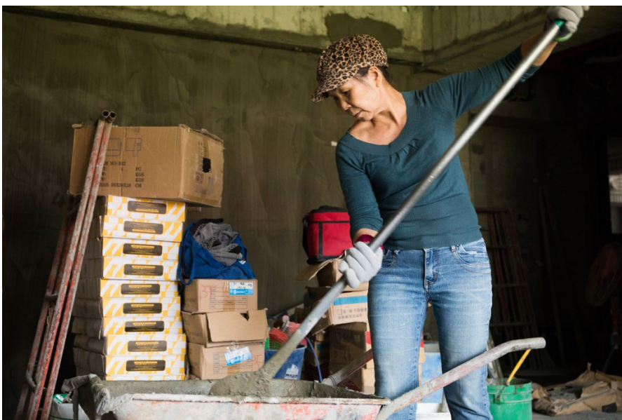
女性工作者在工地裡大部分都做較無技術層面的事。蓮姐用鏟子攪拌水泥後，再鏟給在砌泥底的師傅。
