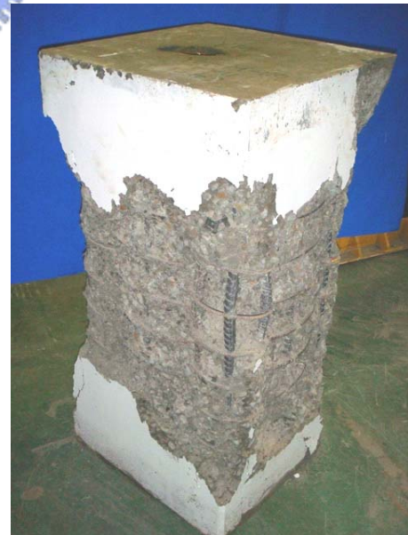
(b) 試體 YW5-M-110 在試驗終止後剝除破裂混凝土之破壞情形
