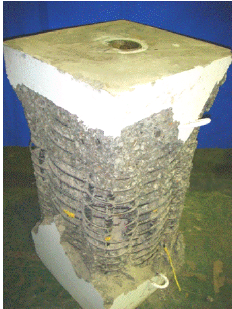
(a) 剝除破裂混凝土後主筋挫屈情形
