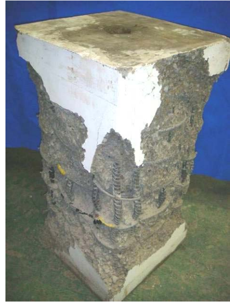
(b) 試體 Y7-M-150 在試驗終止後剝除破裂混凝土之破壞情形
