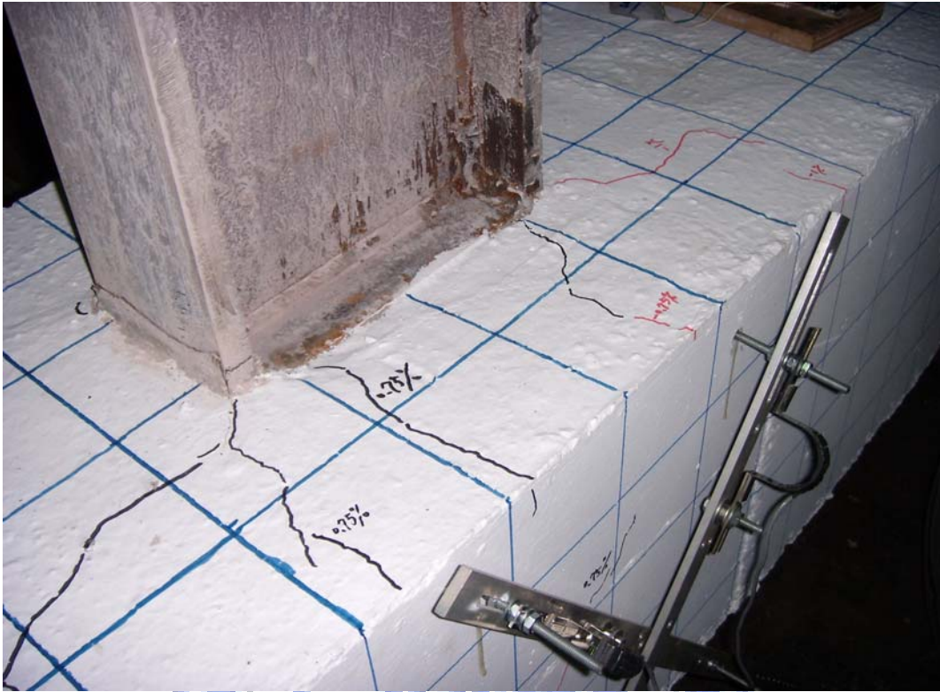
照片 4.1 試體SR0.8-R8 鋼梁下翼板石灰剝落與裂縫情況(1% drift)
