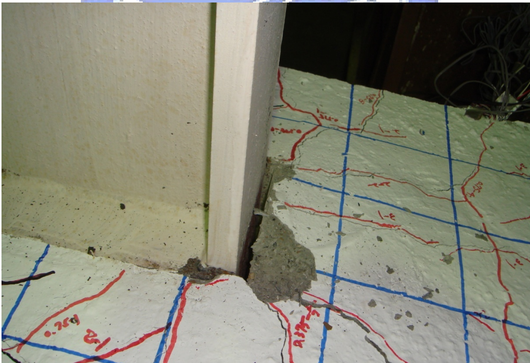
照片 4.38 試體SR0.4-R6 鋼梁翼板周圍混凝土被擠壓約 5 mm 間隙 (3% drift)
