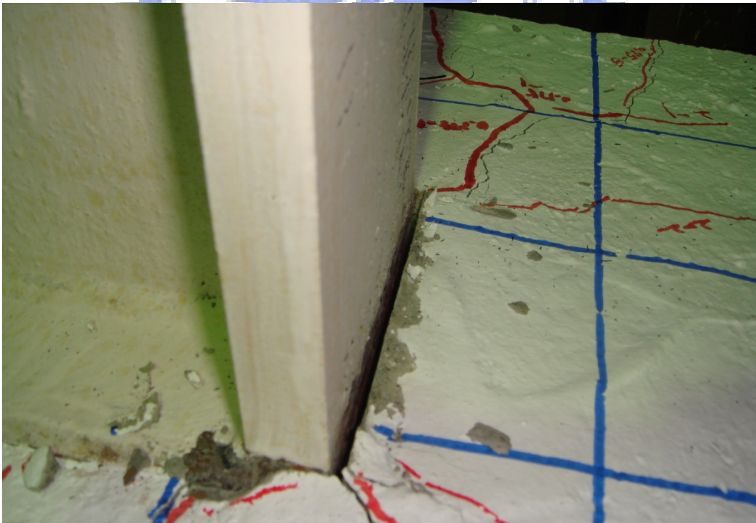
照片 4.36 試體SR0.4-R6 鋼梁翼板周圍混凝土被擠壓約 3 mm 間隙 (3% drift)
