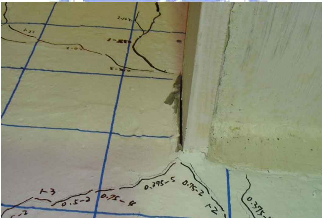
照片 4.14 試體SR0.4-R8 鋼梁翼板周圍混凝土被擠壓約 1 mm 間隙 (2% drift)
