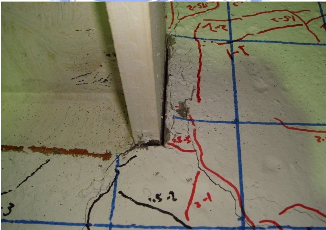
照片 4.30 試體SR0.6-R6 鋼梁翼板周圍混凝土被擠壓約 2 mm 間隙 (3% drift)
