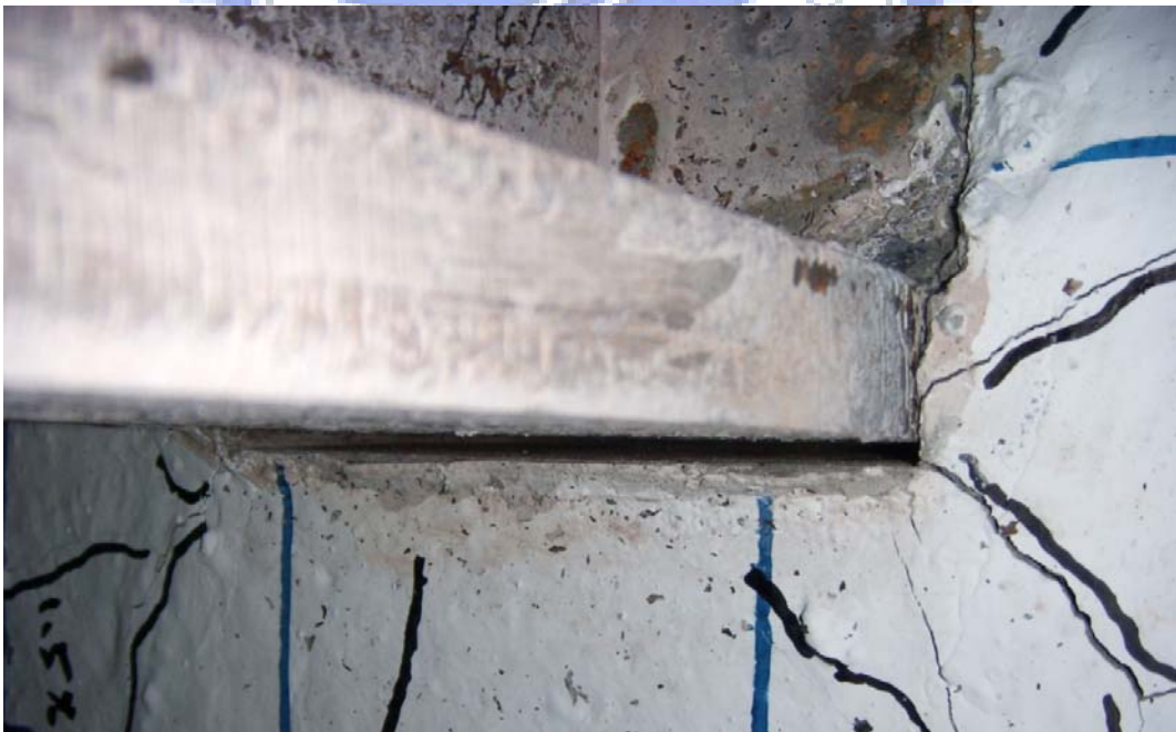
照片 4.4 試體SR0.8-R8 鋼梁翼板周圍混凝土被擠壓約 3 mm 間隙 (4% drift)
