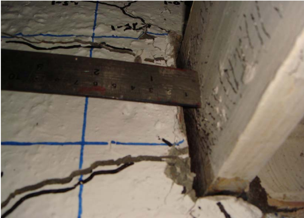
照片 4.11 試體SR0.6-R8 鋼梁翼板周圍混凝土被擠壓約 3 mm 間隙 (4% drift)
