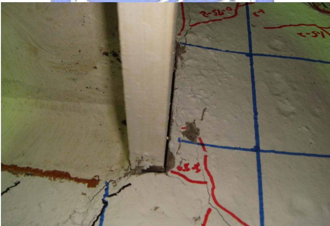
照片 4.28 試體SR0.6-R6 鋼梁翼板周圍混凝土被擠壓約 1 mm 間隙 (2% drift)
