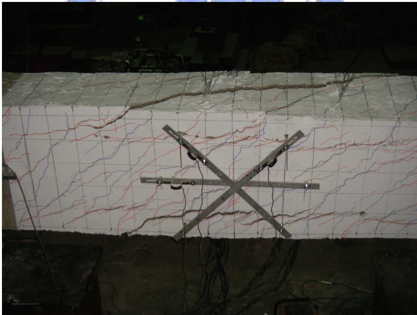
照片 4.11 試體S2-RCt3l2 產生非 45°之斜裂縫
