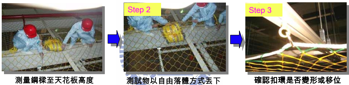
圖 22-5 無塵室天花板專用安全防護網-以砂包實際測試
