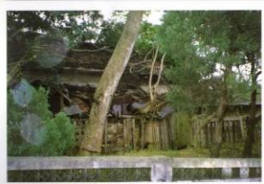
●寫林國小前鄧雨賢遺族所住宿舍，今已倒塌。
