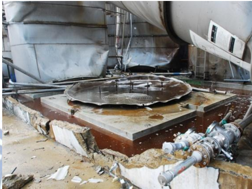
事故現場照片
