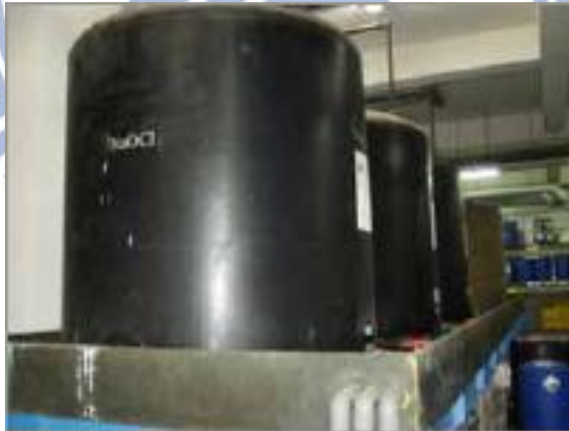
事故現場照片
