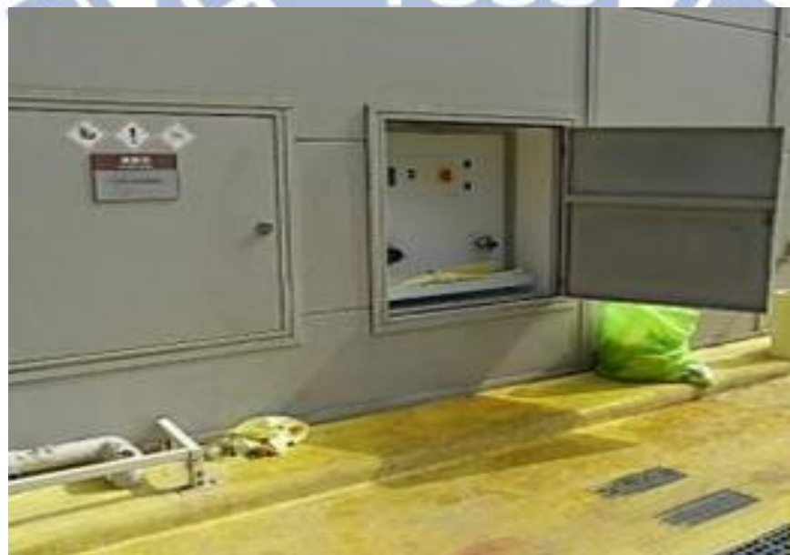
事故現場照片
