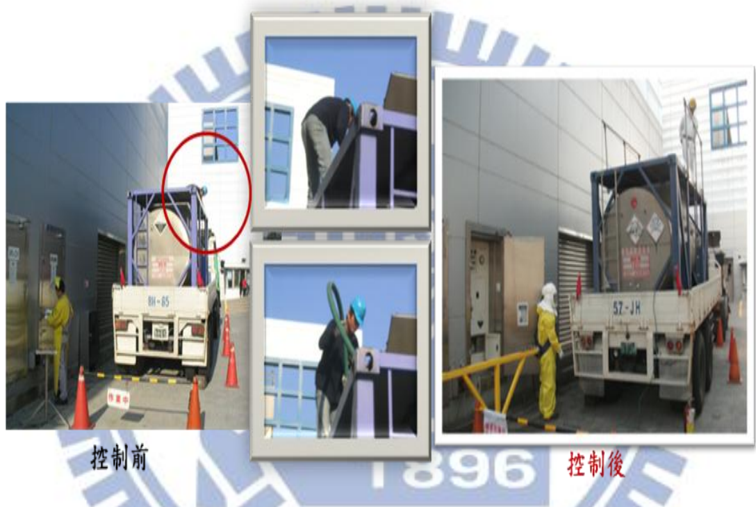
圖 14：槽車墜落改善
