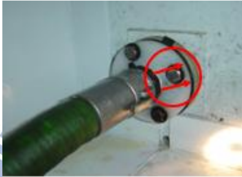
事故現場照片
