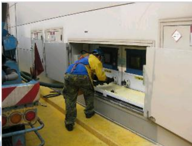
事故現場照片
