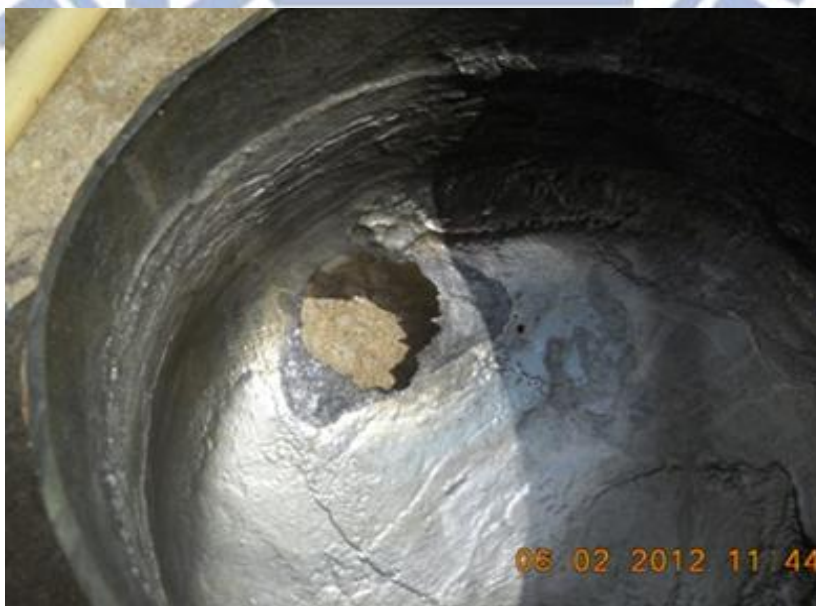
事故現場照片
