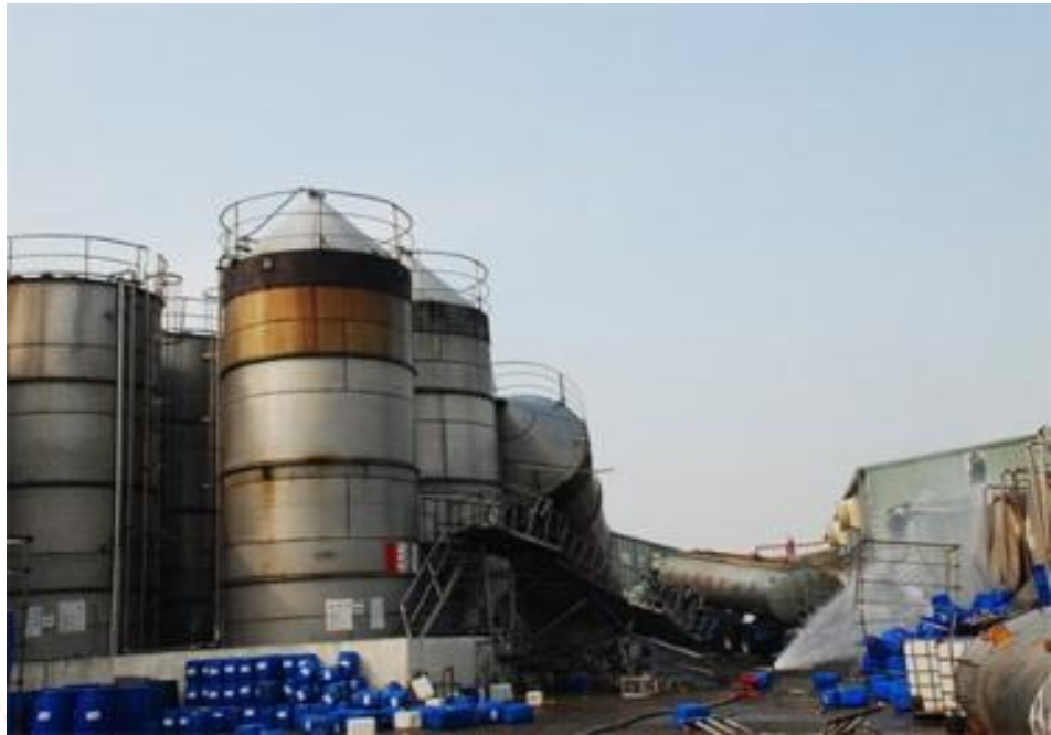
圖 3：協明化工災害現場(2)
