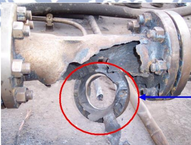
事故現場照片
