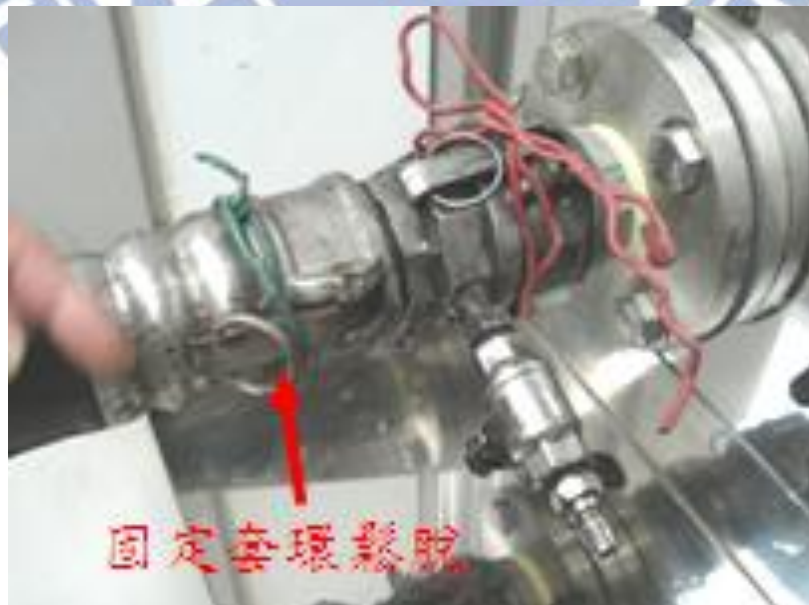
事故現場照片
