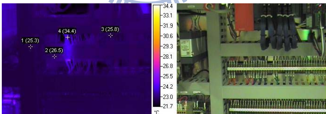
圖4.17配向機02端子台線路老化之熱影像圖(改善後)
