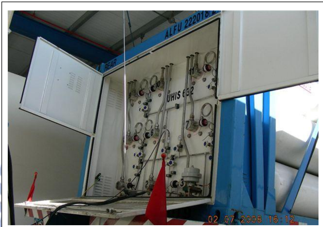
圖 17 矽甲烷槽車之輸送歧管裝置[2]
