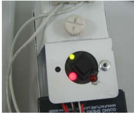
圖 43 自動定時放電之緊急照明燈 資料來源：紅橋實業有限公司
