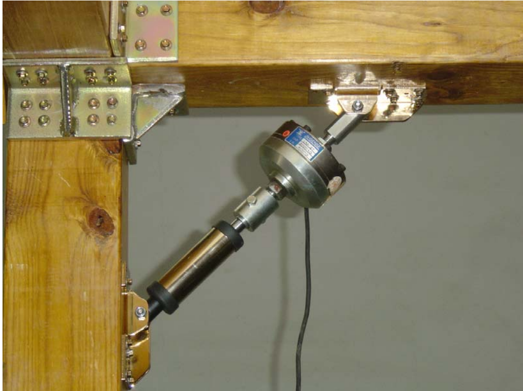
圖 5.64 一樓液流阻尼器之安裝圖
