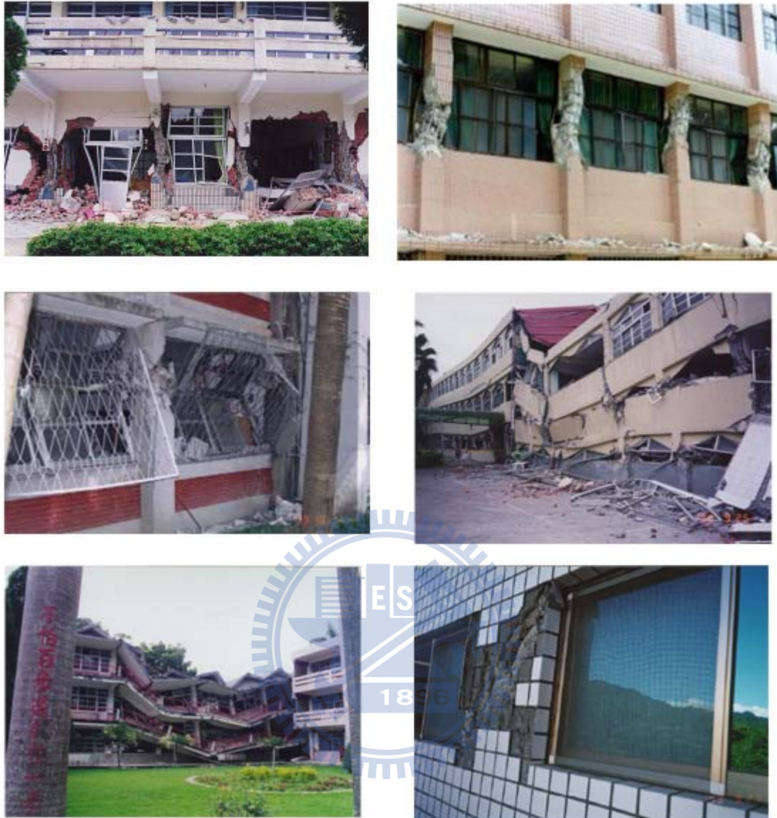
圖1.1 九二一地震中校舍因短柱效應發生柱剪力破壞
