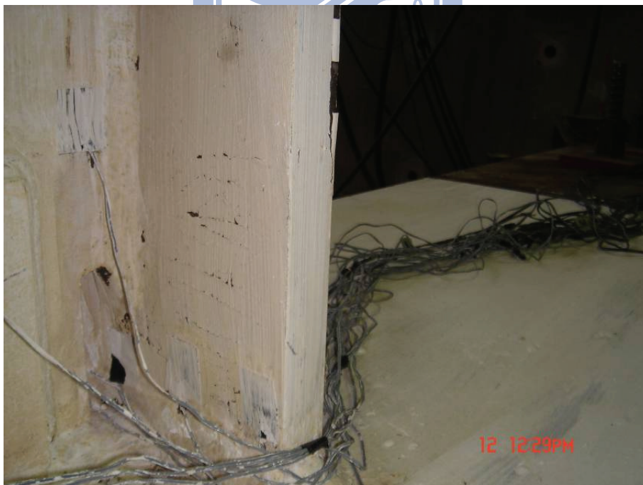
圖 4.41 試體 UN2 下翼板於扇形開孔根部附近出現平行於梁寬度方 向之石灰剝落紋路 (1.5% drift)
