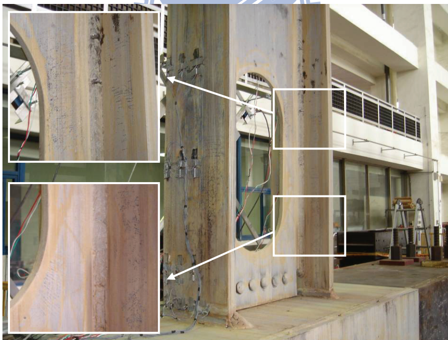
圖 4.78 試體 OP2 上翼板內側近開孔角隅處也出現 45 度方向之石灰剝落紋路 (2% drift)
