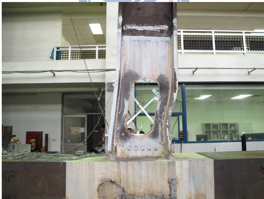
圖 4.66 試體 OP1 開孔區周圍已呈現區域性石灰剝落 (5% drift)
