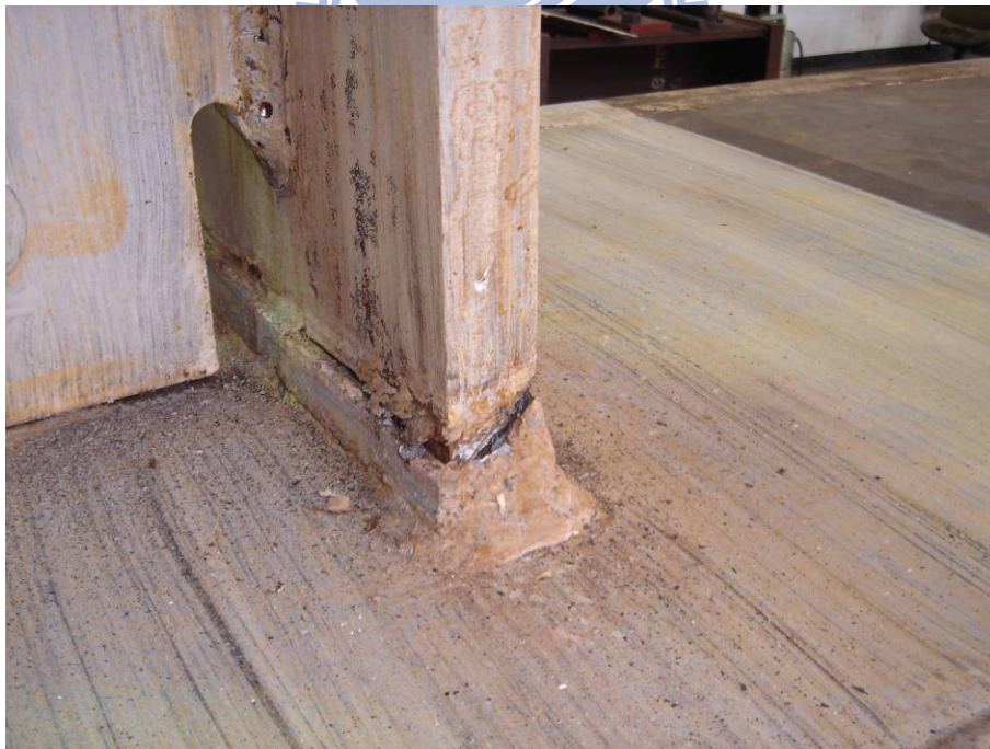
圖 4.80 試體 OP2 走至第二迴圈正方向時上翼板全滲透鐸道處裂縫 沿翼板開槽 45 度方向裂開 (3% drift)
