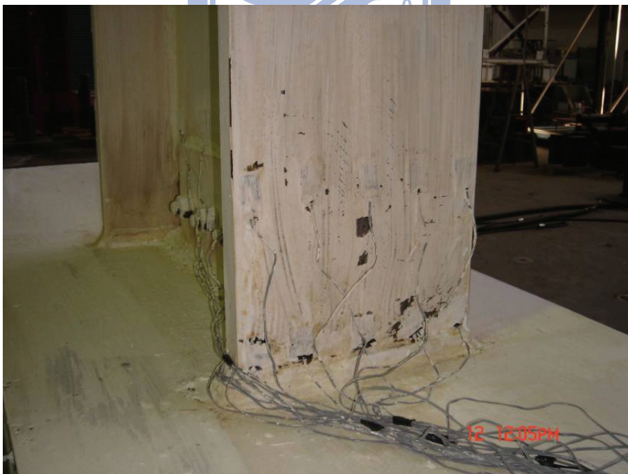
圖 4.39 試體 UN2 下翼板中央出現約 45 度方向之石灰紋路剝落 (1.5% drift)
