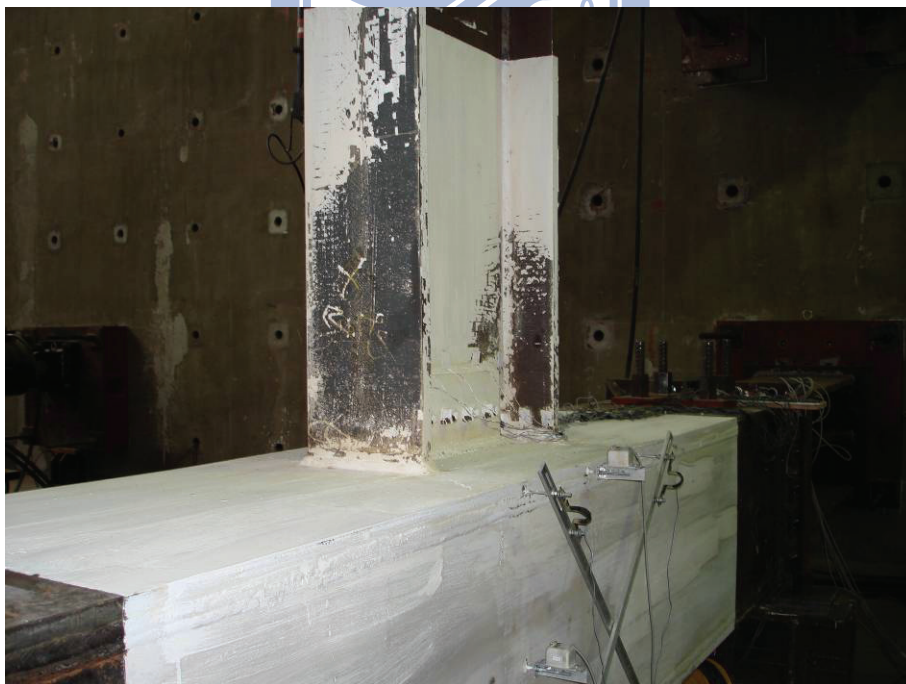
圖 4.43 試體 UN2 梁翼板出現大量且明顯之剝落並從兩側貫穿至翼板中心 (3% drift)
