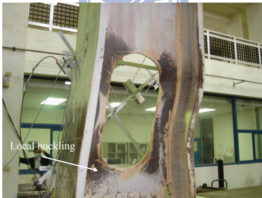
圖 4.68 試體 OP1 開孔角隅近下翼板處產生局部挫屈現象，而近開 孔周圍及上、下翼板處均產生大量石灰剝落 (6% drift)
