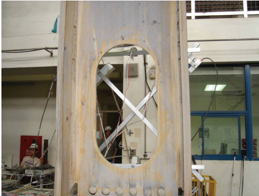
圖 4.77 試體 OP2 於開孔周圍四個角隅之石灰剝落持續發展 (2% drift)
