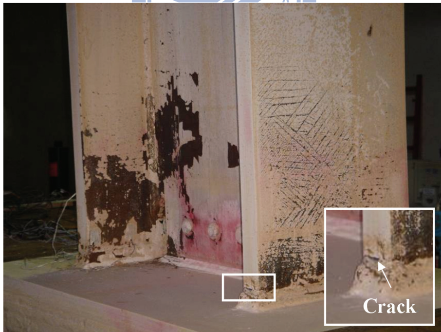
圖 4.31 試體 UN1 梁上翼板全滲透銲道處最外緣產生一小裂縫 (3% drift)
