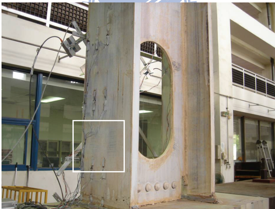
圖 4.54 試體 OP1 於下翼板接近開孔起始端及近柱面全滲透銲道處 出現平行柱面之石灰剝落紋路 (1.5% drift)
