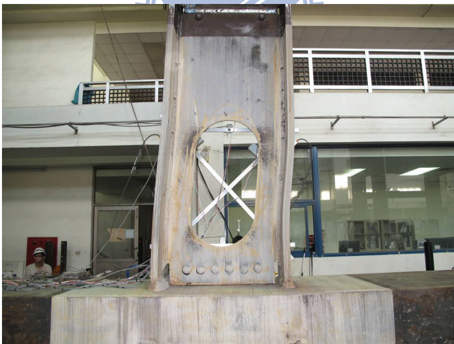
圖 4.82 試體 OP2 於開孔周圍四個角隅處出現大量石灰剝落紋路 (4% drift)
