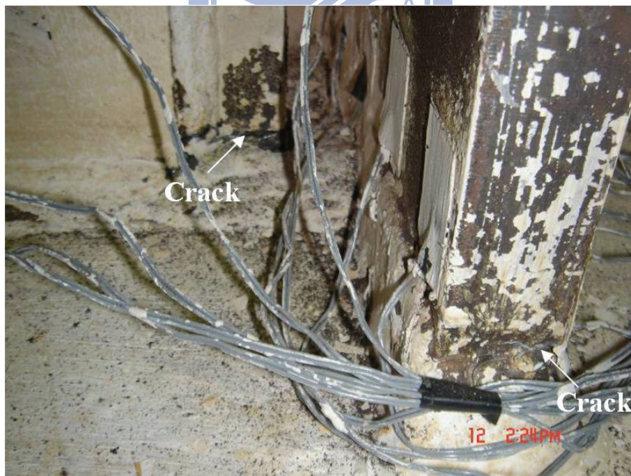
圖 4.47 試體 UN2 剪力板與柱面連接之鉚道及下翼板與柱面連接之 全滲透鉚道均產生一明顯之裂縫 (4% drift)
