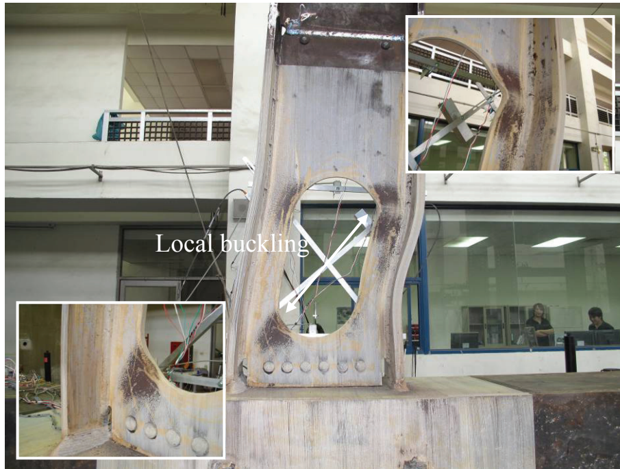
圖 4.87 試體 OP2 於開孔區對角線方向之角隅均出現嚴重面外挫屈 (7% drift)
