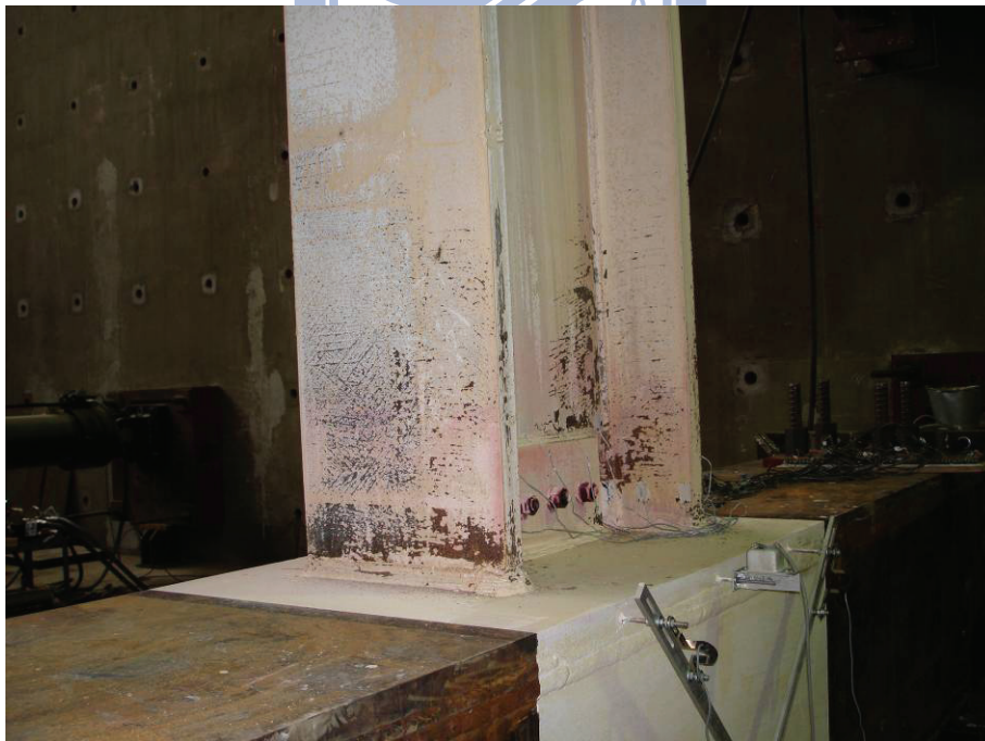
圖 4.33 試體 UN1 梁翼板及腹板處石灰剝落仍持續發展 (4% drift)
