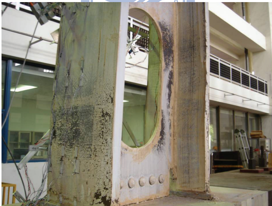
圖 4.60 試體 OP1 於上、下翼板及開孔區周圍出現區域性大量石灰剝落，並有向開孔中心發展趨勢 (3% drift)
