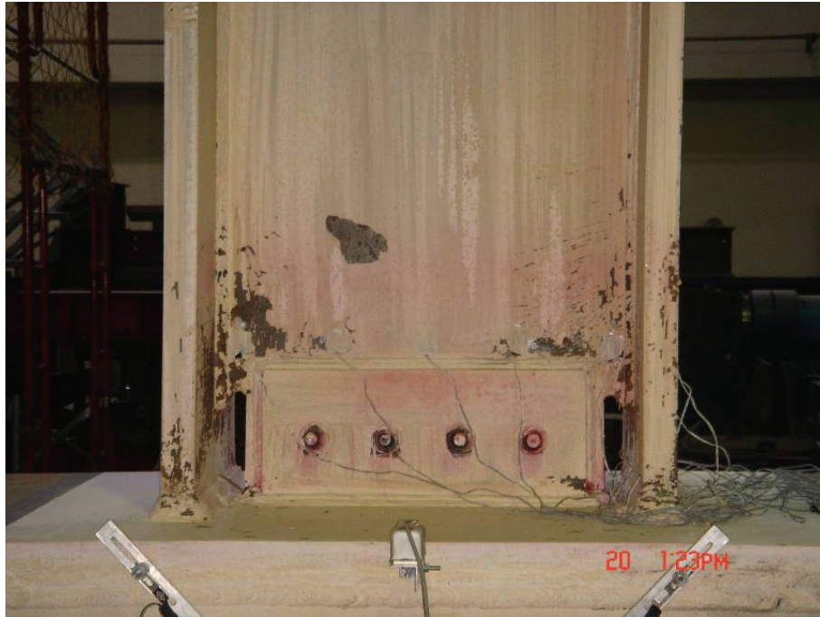
圖 4.30 試體 UN1 梁腹板近扇形開孔處之石灰剝落開始向上發展； 剪力板與柱面之銲道最外緣也開始產生石灰剝落 (3% drift)
