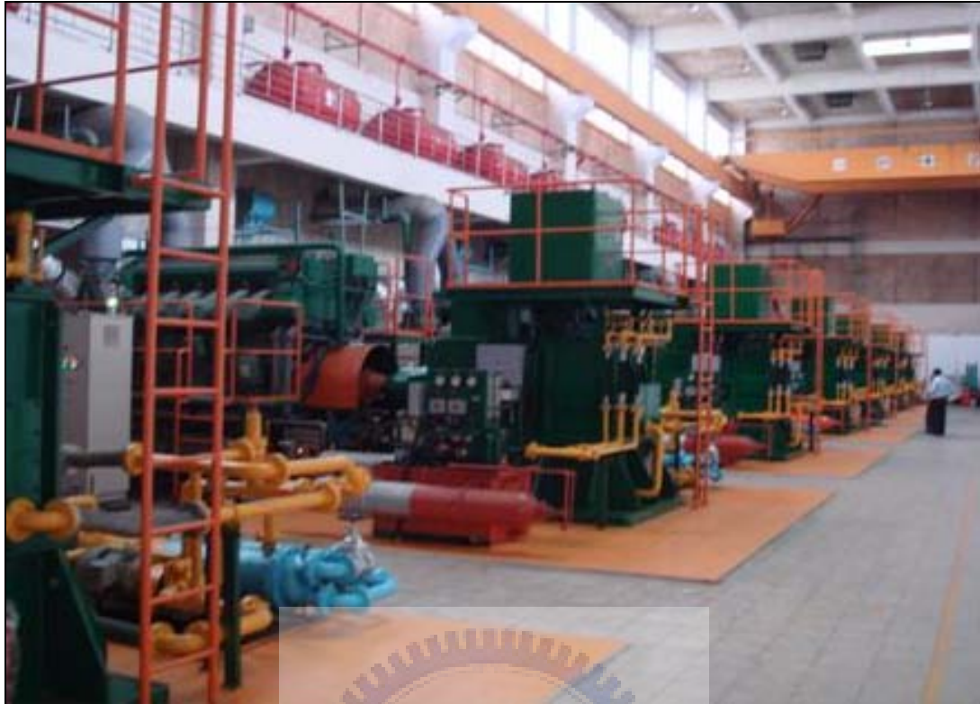
圖 4-8 抽水機組配置現況
