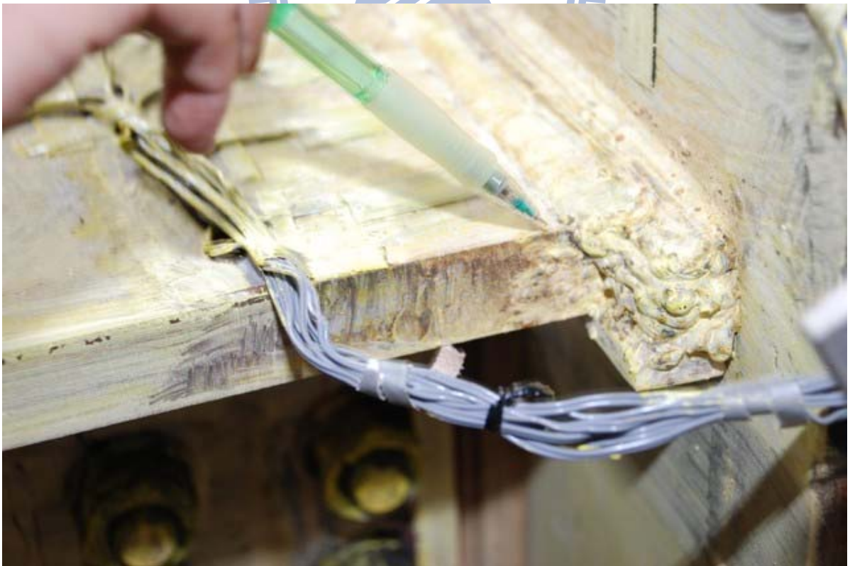
照片 3.12 試體 UR 梁上翼板與柱板接合之焊道產生裂縫 ( \theta = -2\% 弧度)
