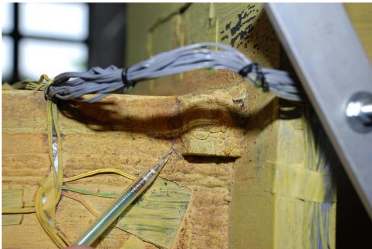
照片 3.129 試體 IFS3 梁柱焊道裂痕情形 ( \theta = -6\% 弧度)
