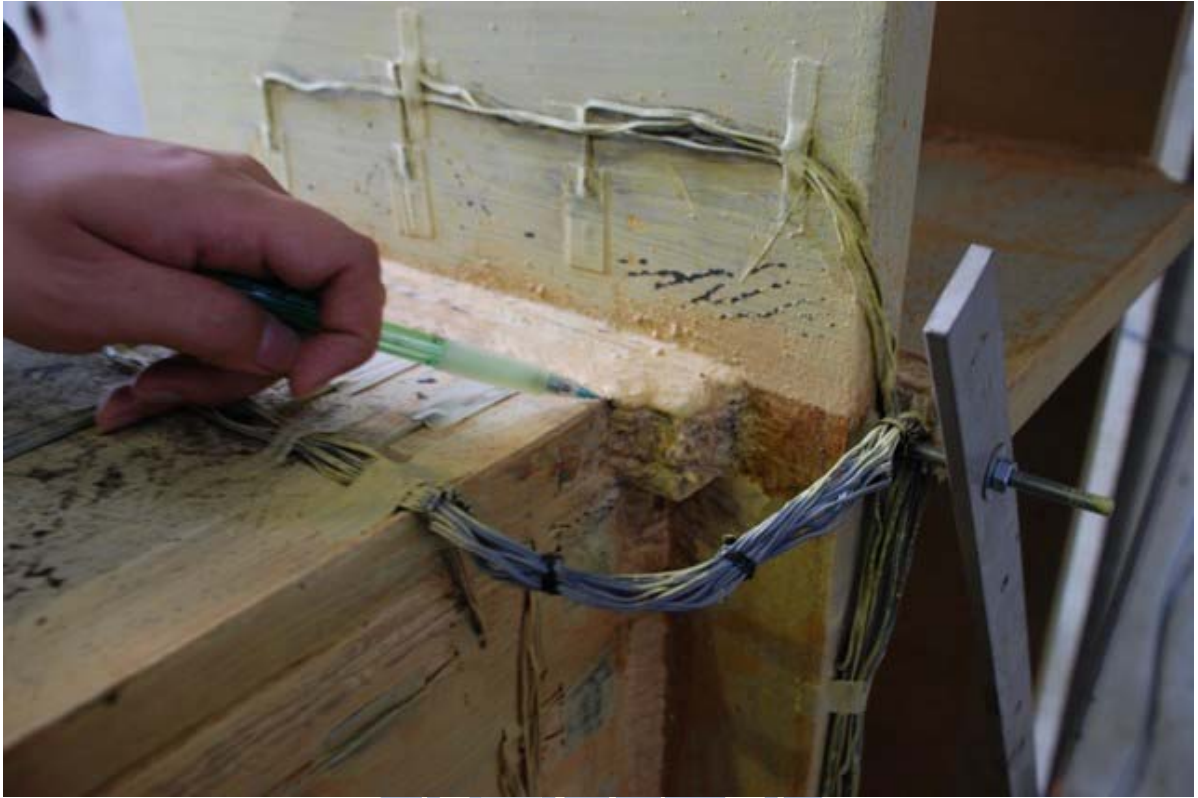
照片 3.75 試體 IFS2 第二次試驗時梁上翼板焊道產生裂痕 ( \theta = -1\% 弧度)
