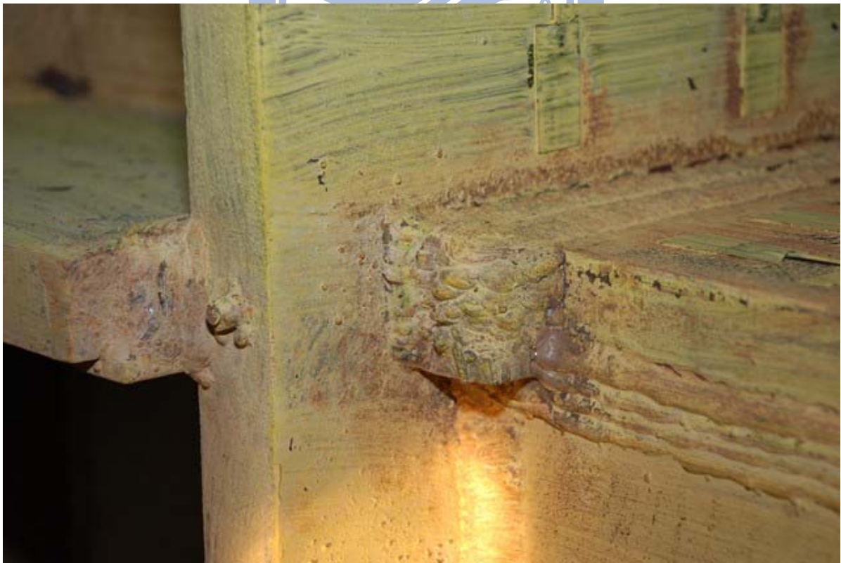
照片 3.128 試體 IFS3 梁柱焊道裂痕情形 ( \theta = -6\% 弧度)
