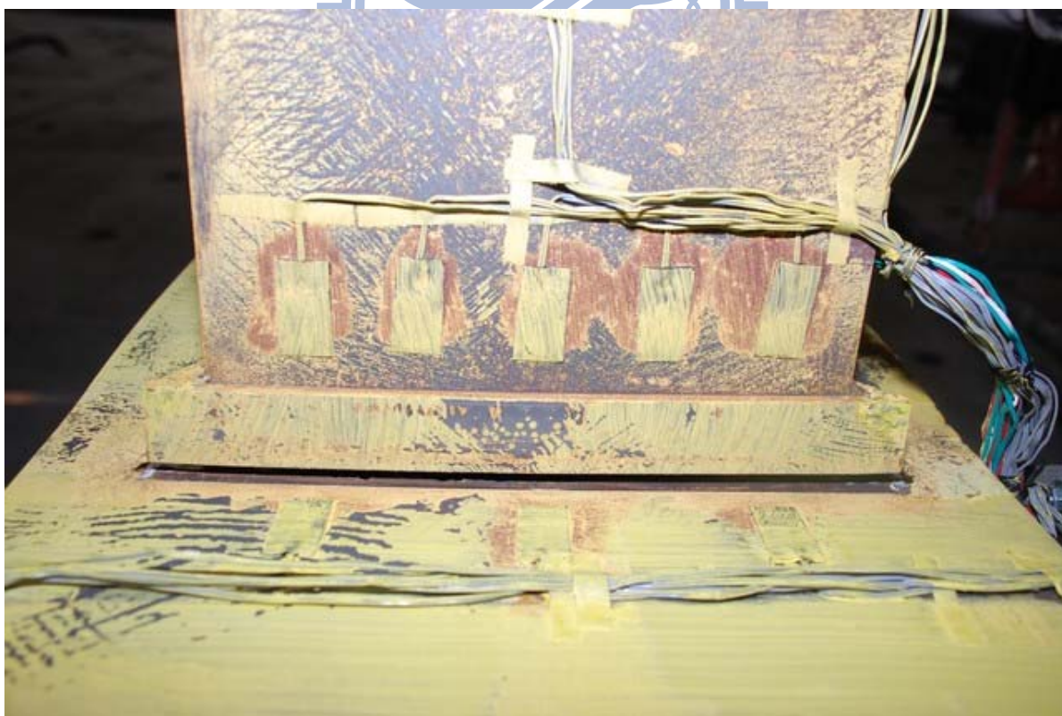
照片 3.136 試體 IFS3 梁下翼板焊道和柱板交界斷裂 ( \theta = +6\% 弧度第二圈)
