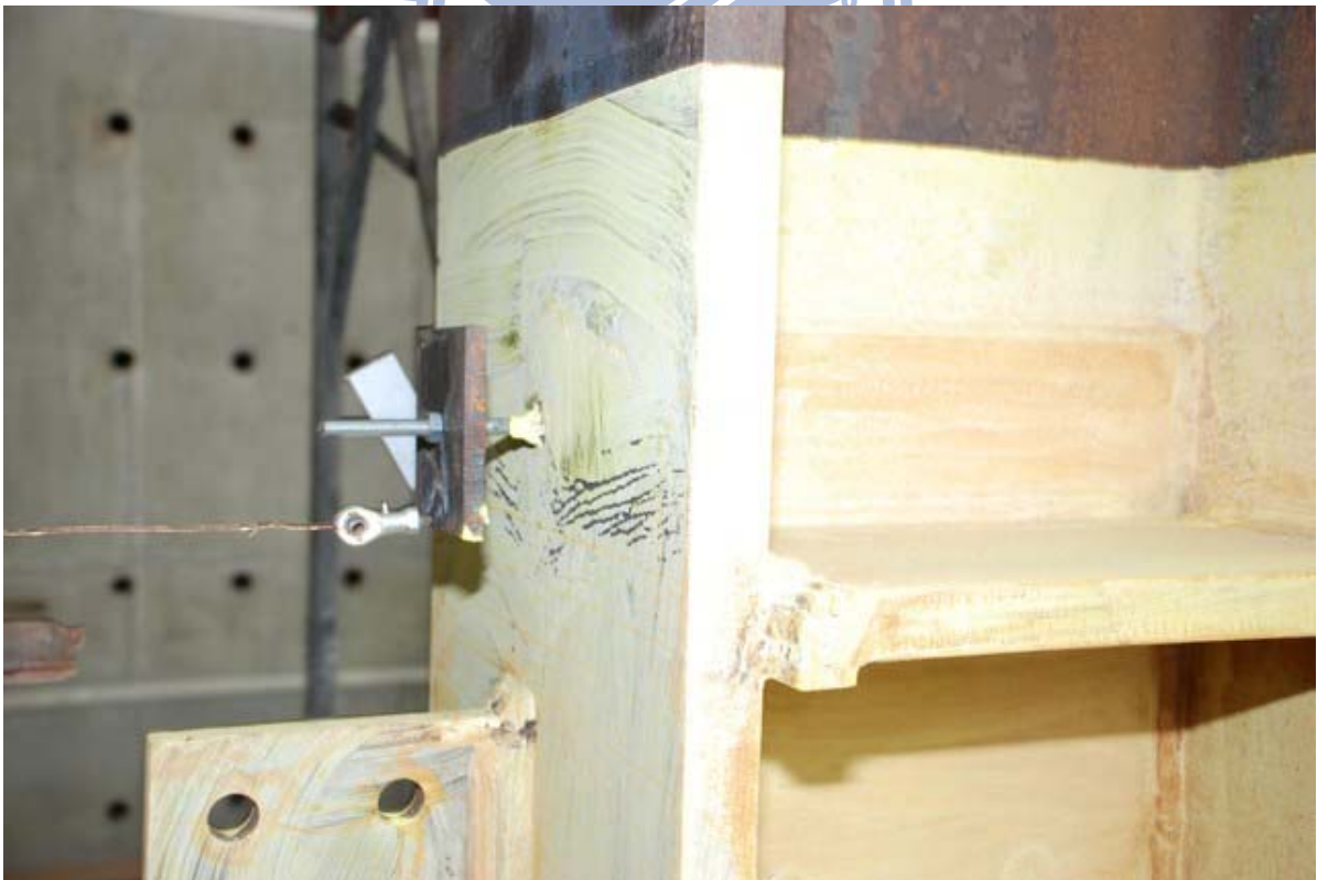
照片 3.42 試體 IFS1 背側柱板於上橫隔板處降伏情形 ( \theta = -4\% 弧度)
