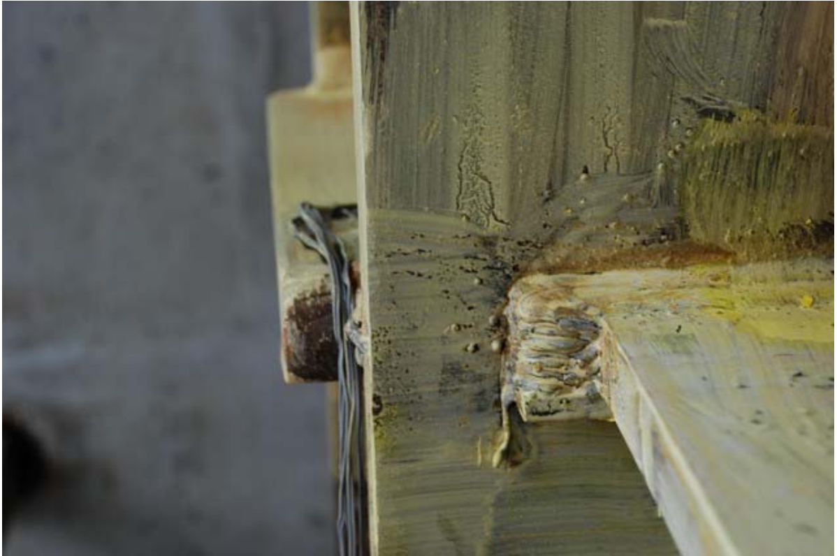
照片 3.9 試體 UR 柱板位於梁下翼板焊道外側處降伏 ( \theta = +1\% 弧度)
