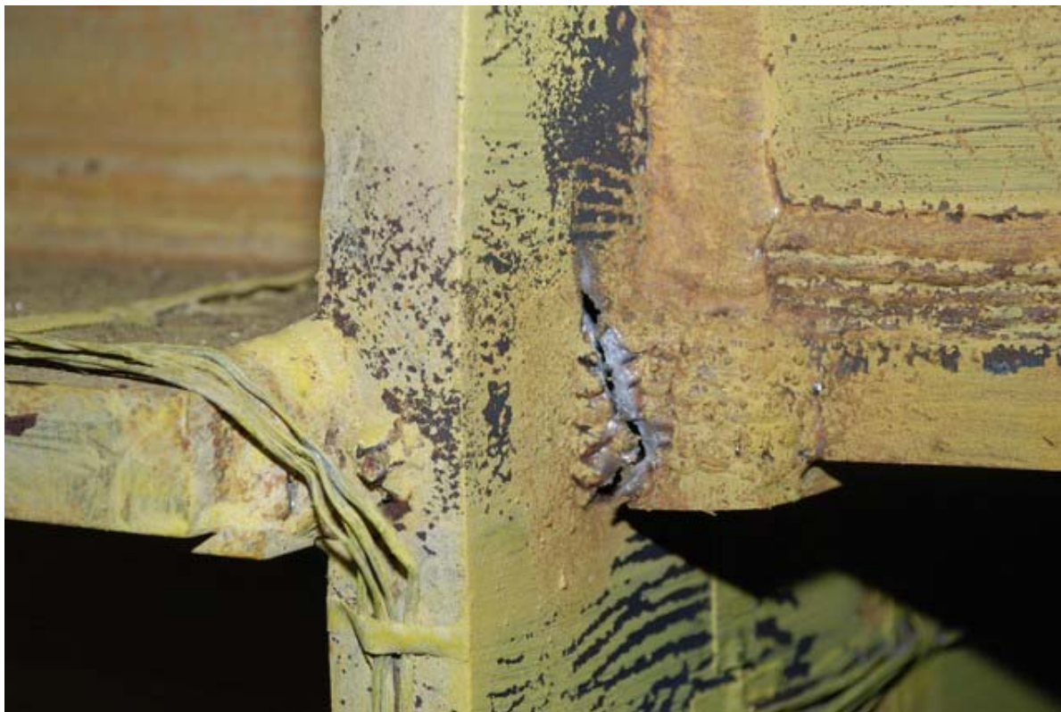
照片 3.137 試體 IFS3 梁下翼板焊道和柱板交界斷裂( \theta = +6\% 弧度第二圈)
