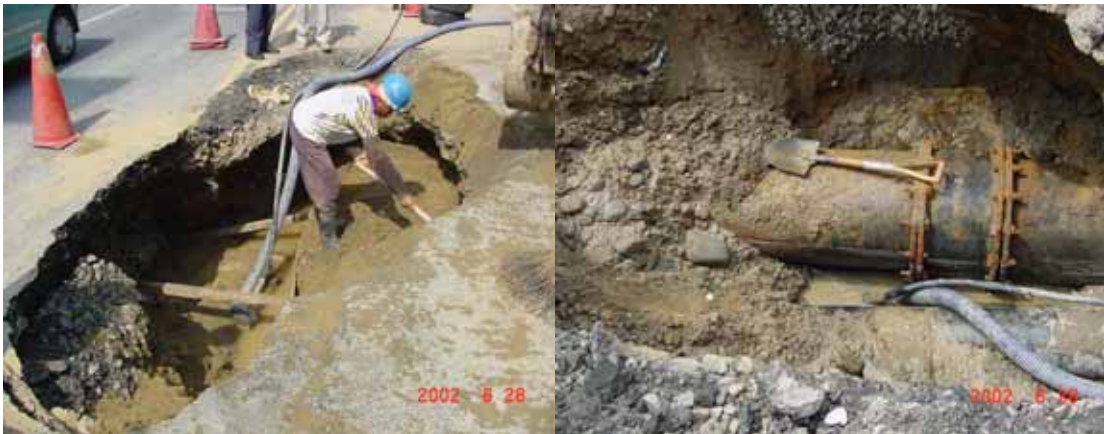
(a) 塌孔內部狀況
