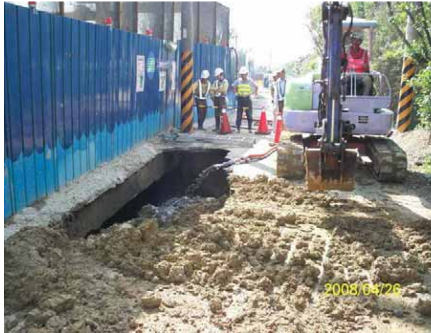
(a)路面沉陷（遠照）
