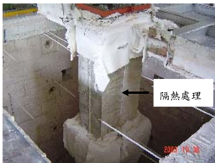
圖 24 角柱火害試驗現況
