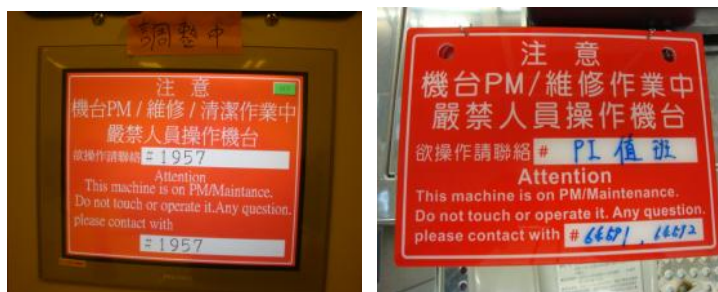
圖4-6控制盤切換至維修模式或懸掛 PM/維修告示牌
