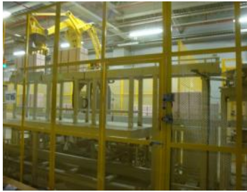
圖4-1 工業用機器人應有護欄、連鎖裝置
