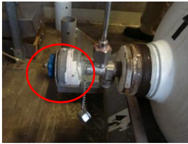
圖2-10 矽甲烷鋼瓶緊急遮斷閥
