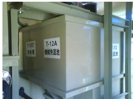
圖 3-7 快混槽及慢混槽
