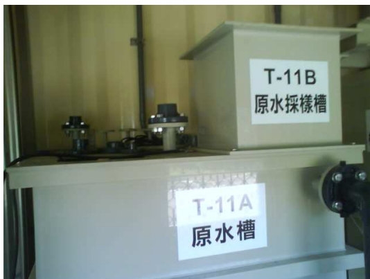
圖 3-6 原水槽及原水採樣槽
