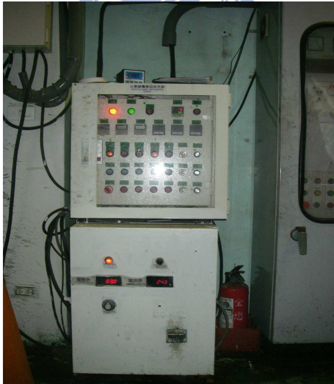
圖 3-6 電解設備變壓器及控制盤
