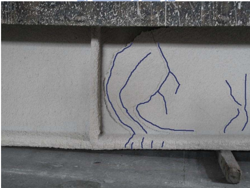
圖 3-55 試體 3 試驗後防火被覆裂縫
