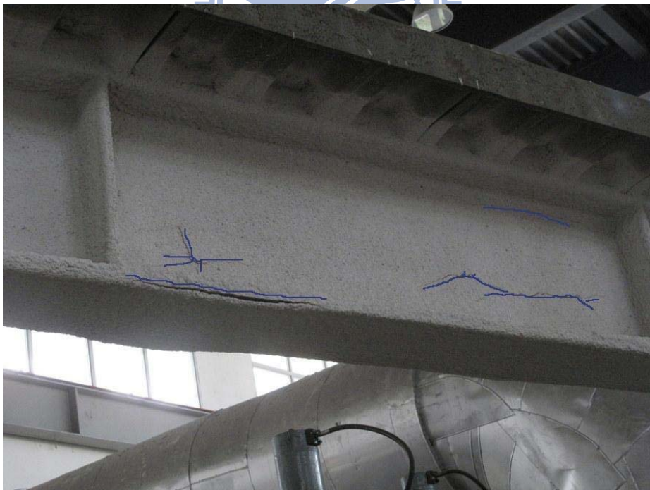
圖 3-45 試體 1 試驗後防火被覆裂縫
