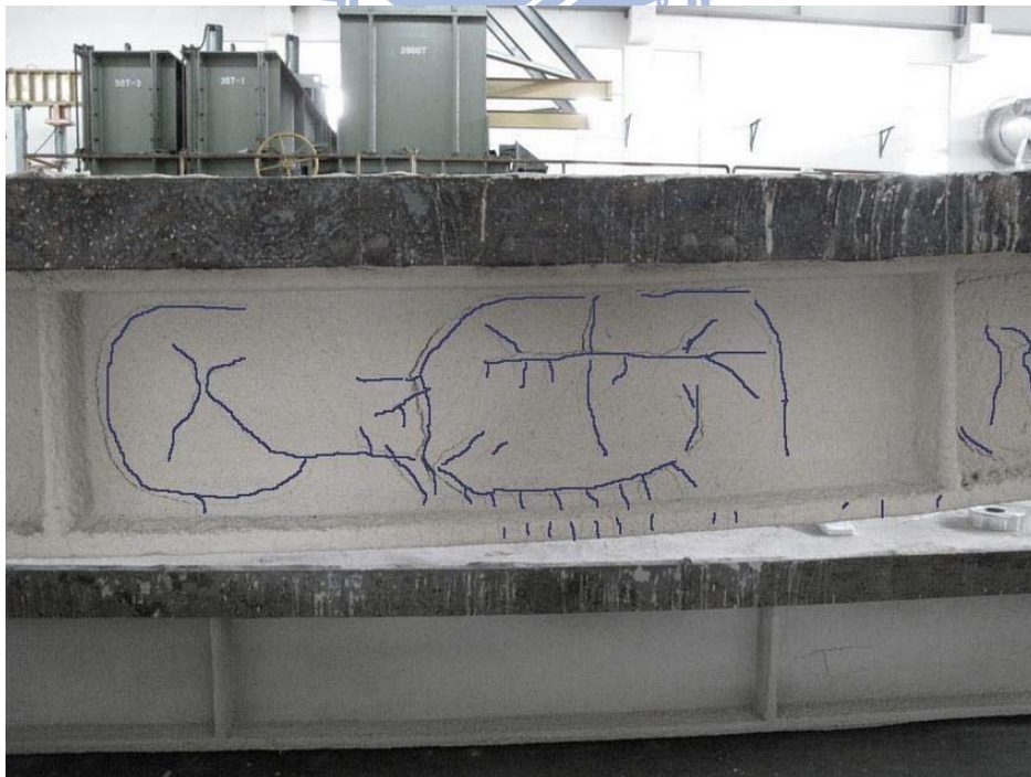
圖 3-49 試體 2 試驗後防火被覆裂縫
