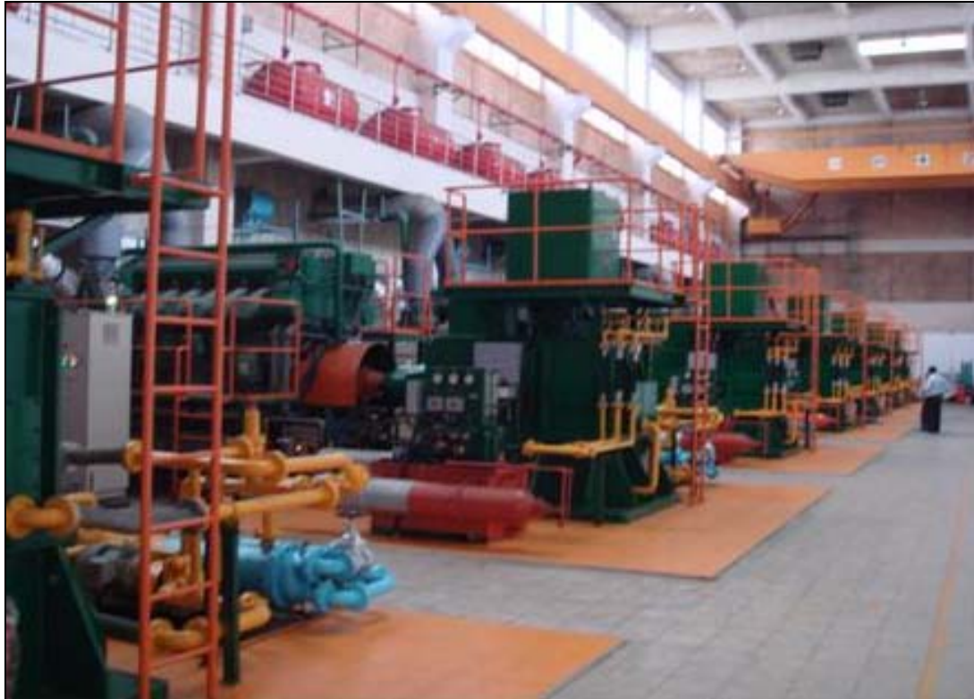
圖 4-7 抽水機組配置現況
