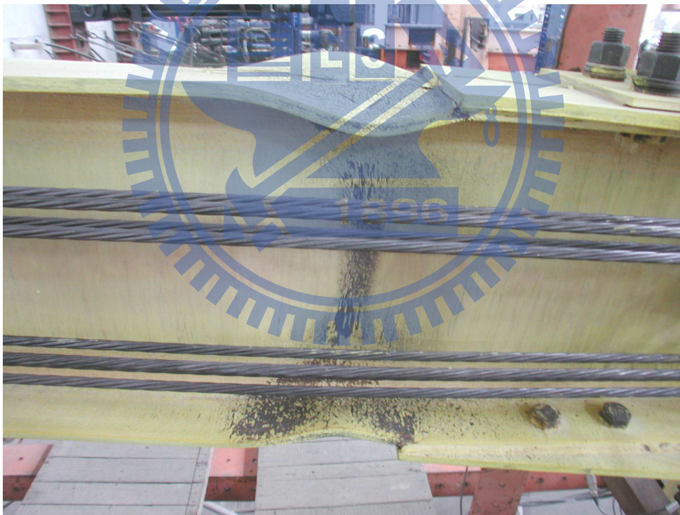
照片 3.1 梁挫屈 (試體 1), 3%側位移角
