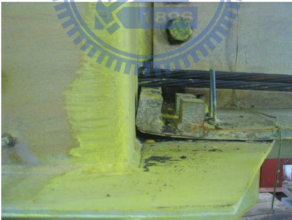
照片 3.9 梁翼撓曲破壞 (第一次試驗)
