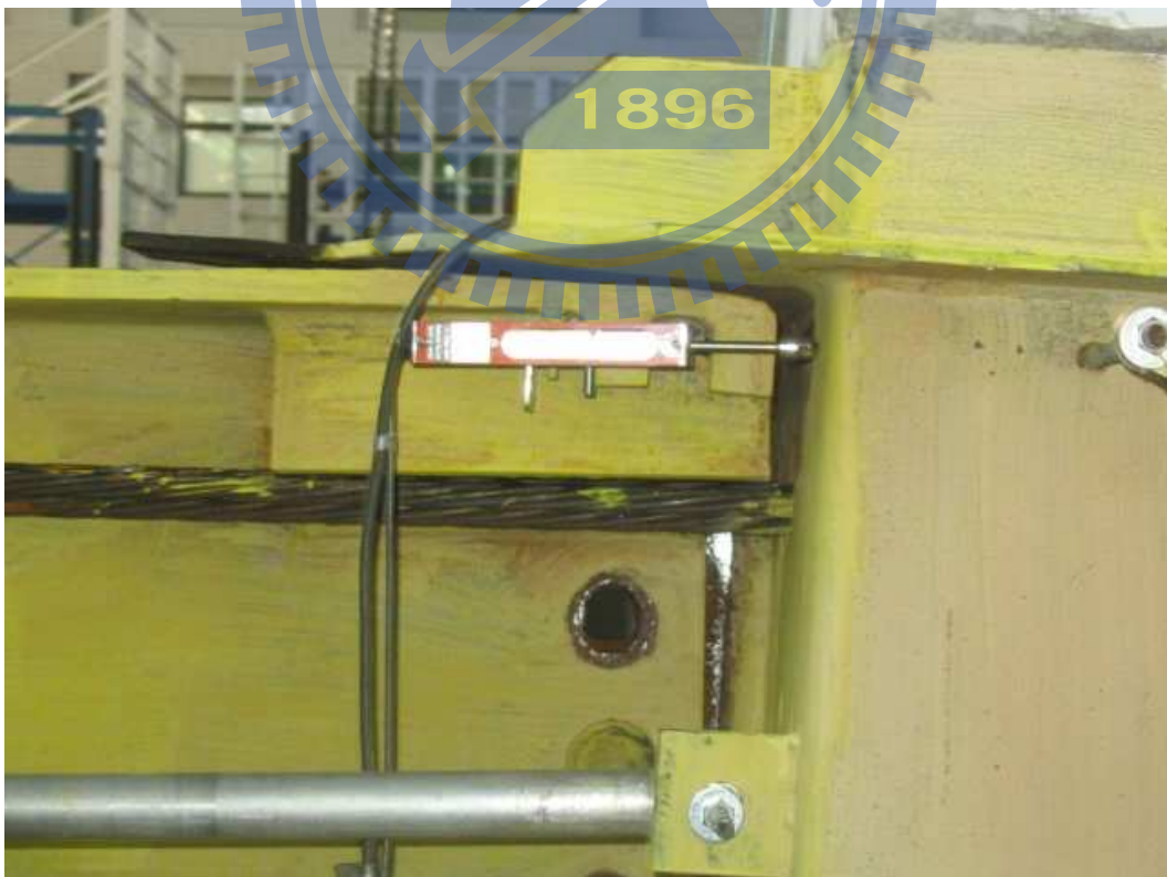
照片 3.15 梁柱界面分離 (第三次試驗)
