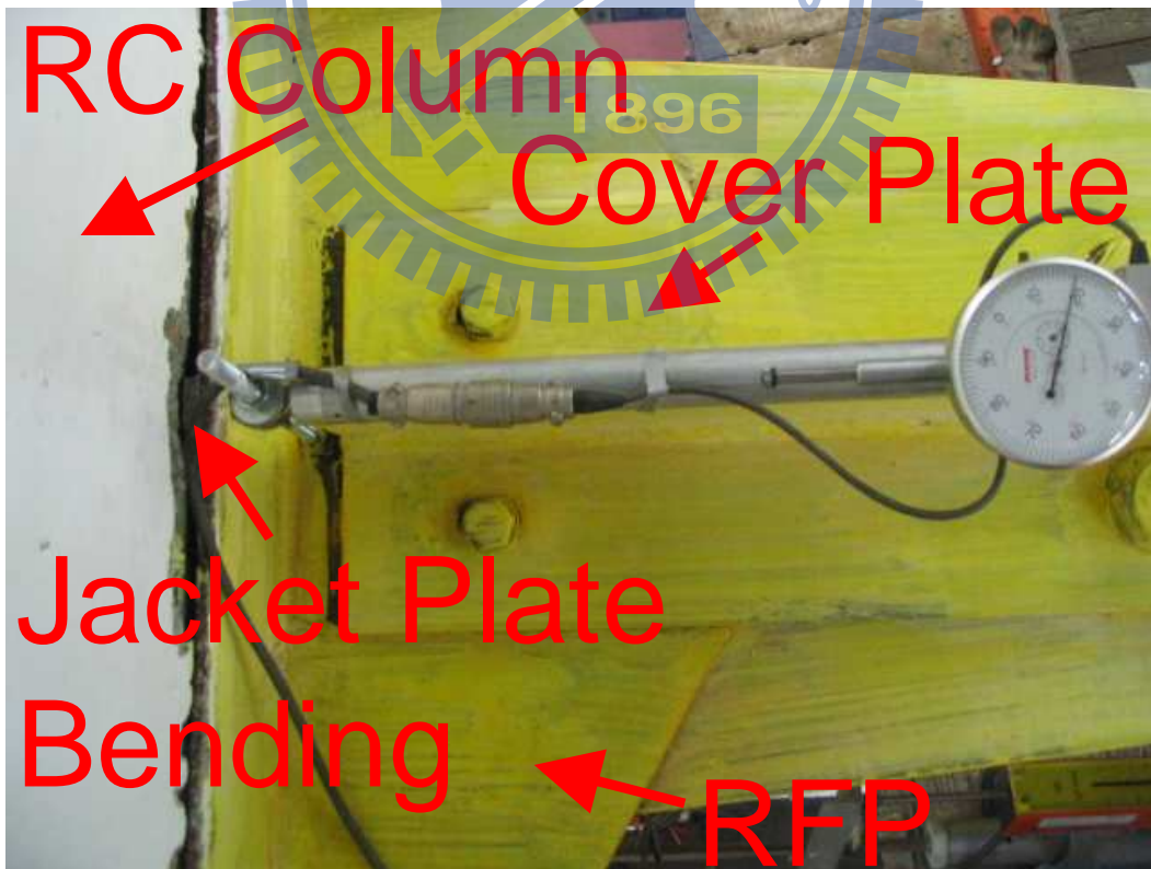
照片 3.11 包覆鋼板與柱面分離(第一次試驗)
