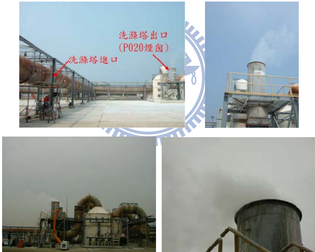
圖 3-1 某光電廠屋頂煙囪出口採樣點
