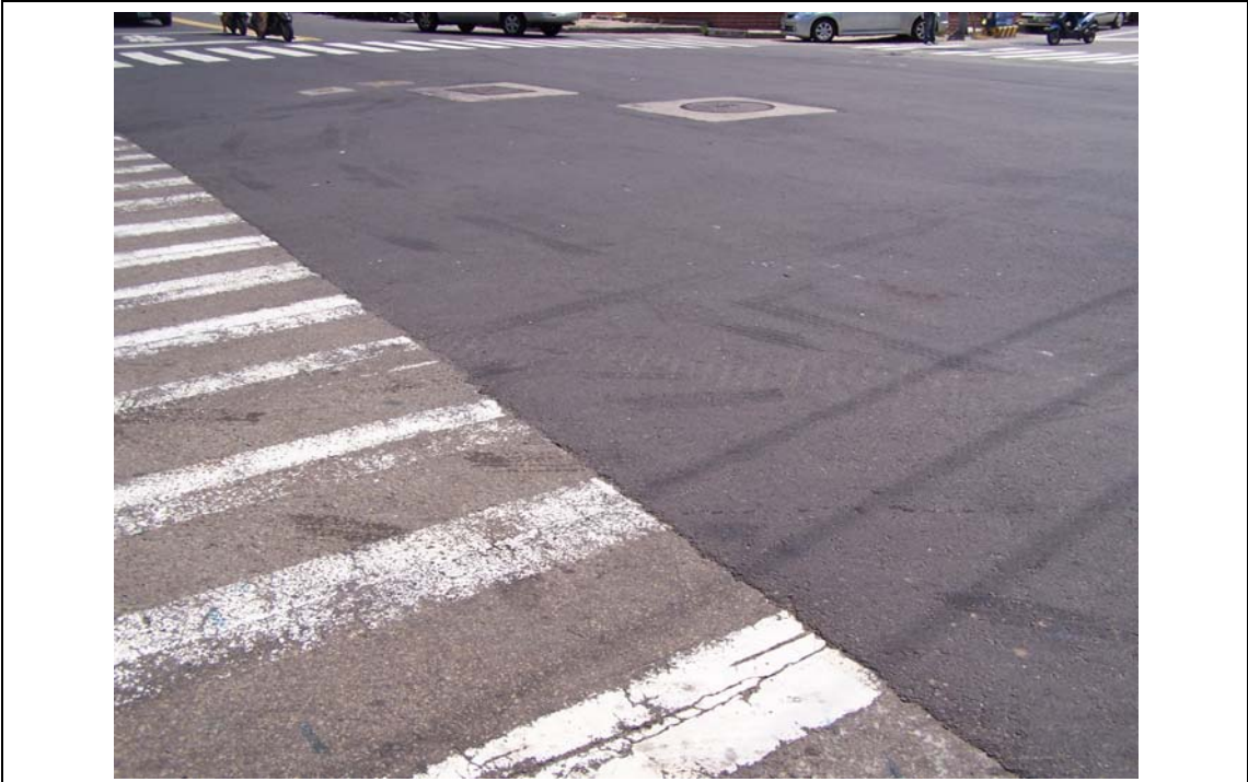
照片 4.2.3-1a 現場採證事故現場 (案例 1A01)
