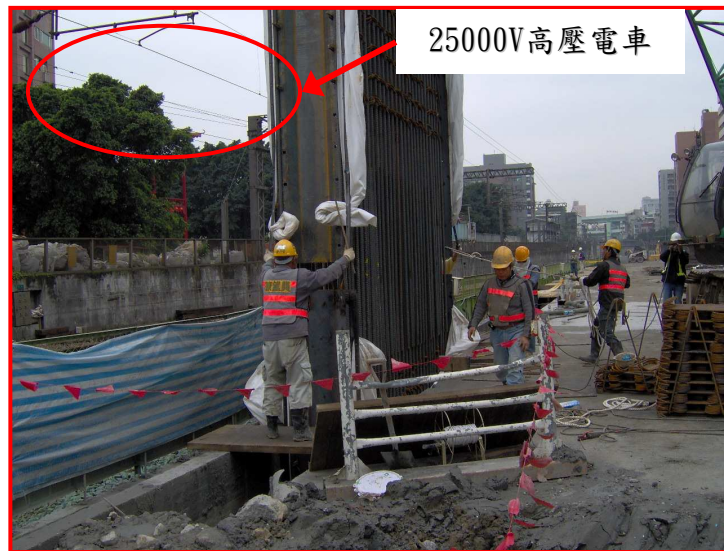
圖 58 危險的吊掛作業
