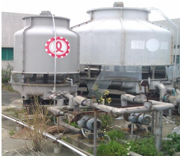
圖 3-2-6、冷卻水塔(右)、冷卻水塔-A(左)
