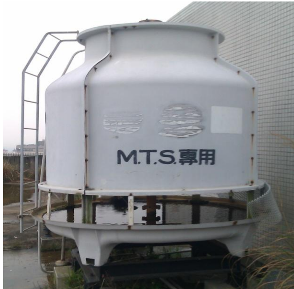
圖 3-2-5、冷卻水塔-B(良機)
