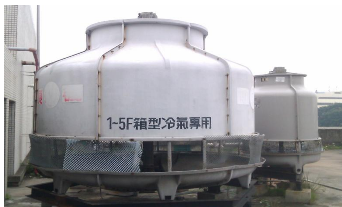
圖 3-2-2、箱型冷氣專用水塔
