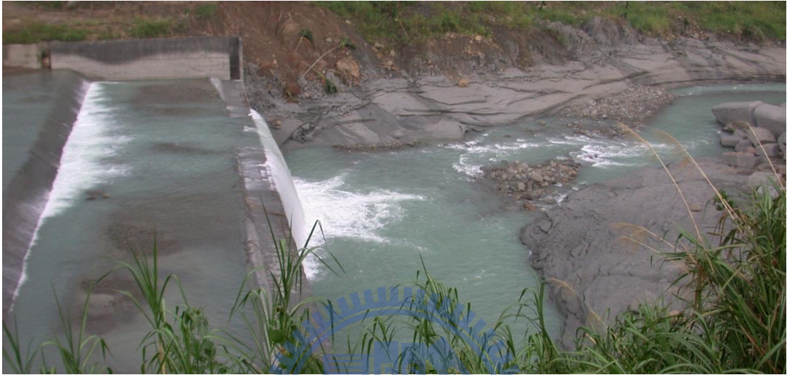
圖 2-1 觸口攔河堰堰體懸空情形(攝於 20050729)
