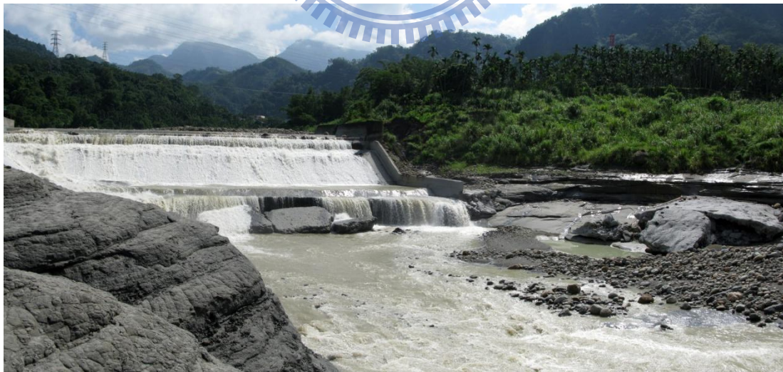
圖 3-5 觸口堰增設第二階護坦後之沖刷(20081007)
