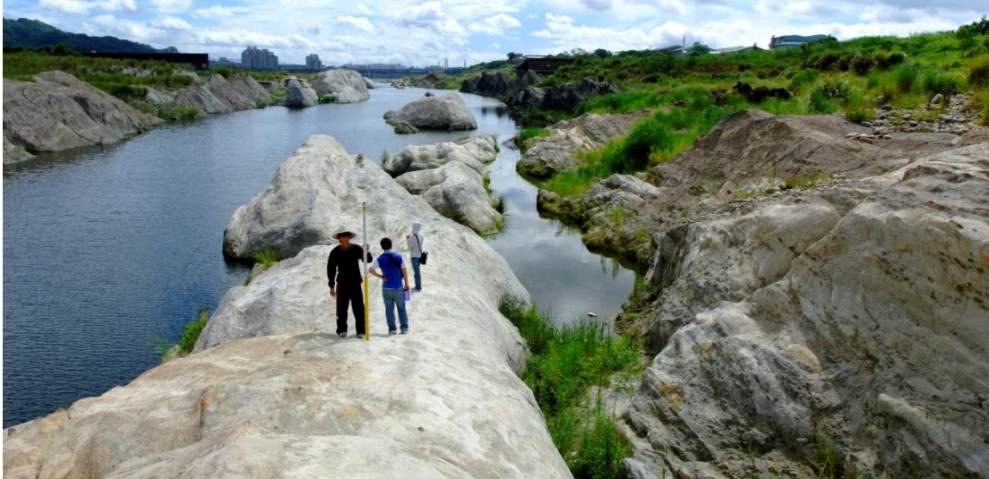
圖 2- 3 後村攔河堰堰體斷裂情形(攝於 20090803)
