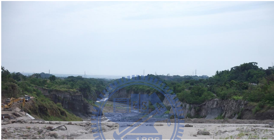
圖 3-27 攔河堰下游沖刷引起之河道深槽化(八掌溪仁義潭攔河堰，攝於 20110615)
