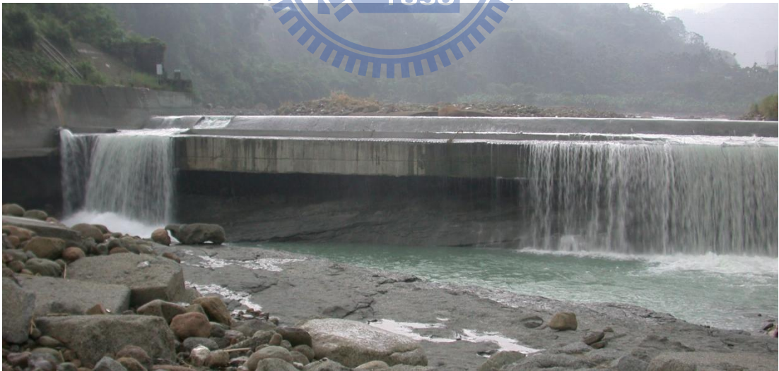
圖 2-2 觸口攔河堰堰體懸空情形(攝於 20050729)
