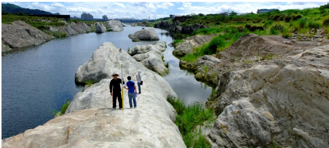
圖 4-4 後村攔河堰現地沖刷狀況
