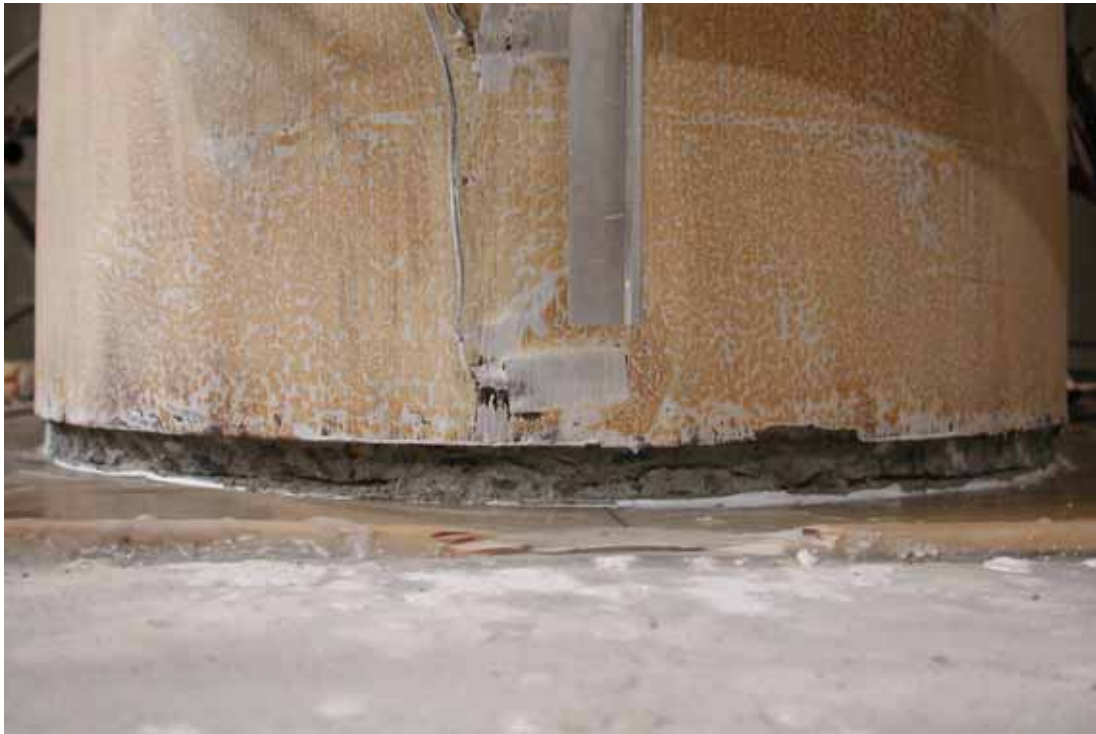
照片 3.43 試體 SP1 試驗後柱底混凝土情況
