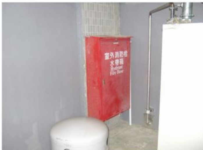
圖 16 二乙基鋅(DEZn)中央配送站內室外消防栓示意圖
