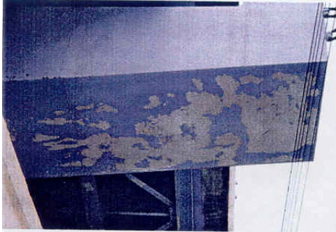
圖 2.1 鋼材表面塗膜劣化剝離
