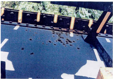
圖 2.4 鋼梁表面褪色、白亞化及孔蝕
