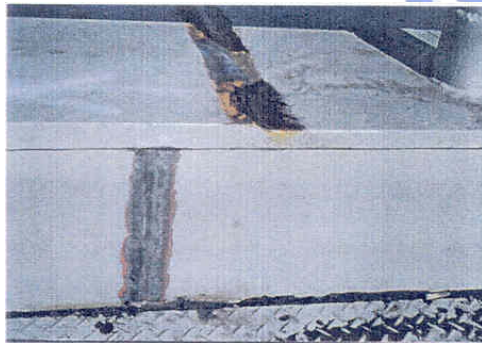
圖 2.11 焊道處防銹處理不良造成銹蝕
