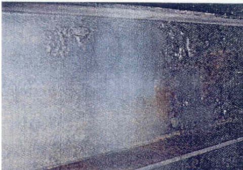
圖 2.3 鋼材表面起泡浮腫
