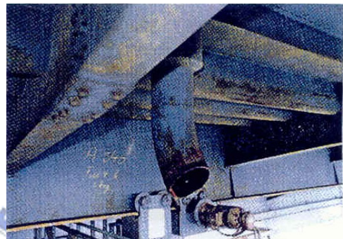
圖 2.14 排水管出口處附近產生銹蝕
