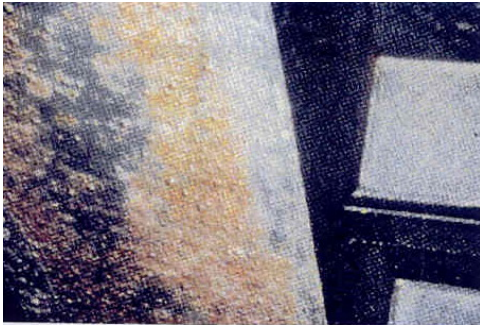
圖 2.2 鋼材表面起泡浮腫
