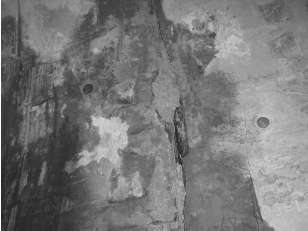
圖 5-61 潛盾隧道下行線第 1066 與 1067 環發生段差與裂紋 (摘自 大陸工程，2003)
