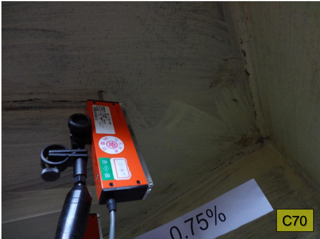
圖 4.84 試體 C70 斜撐北端接合板下緣石膏漆開始脫弱(2) (DR=0.75%)
