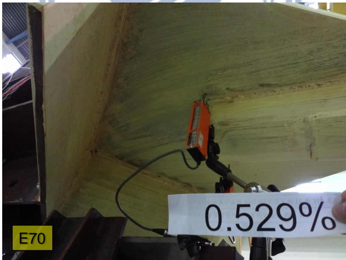
圖 4.71 試體 E70 斜撐北端接合板有些微石膏漆脫弱 (DR=0.529%)
