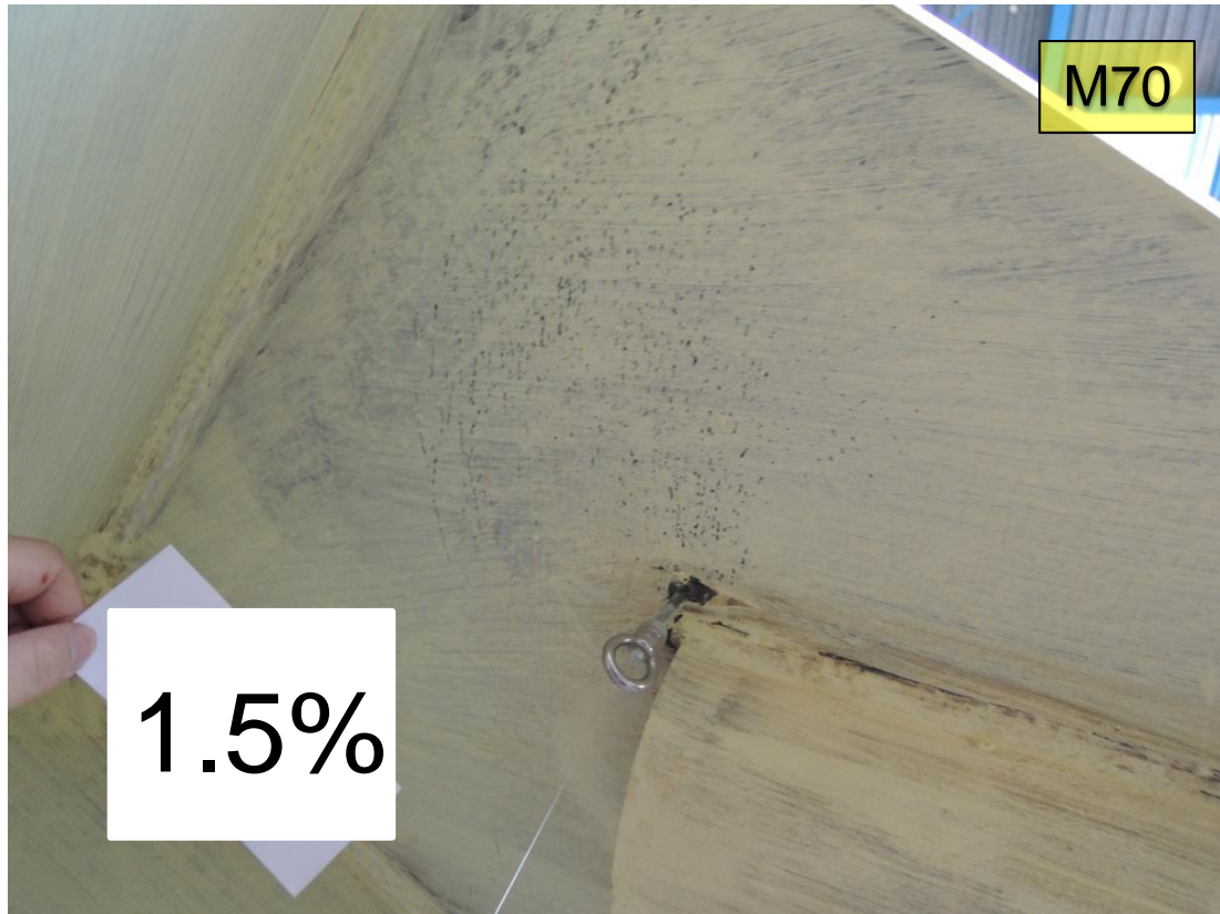
圖 4. 65 試體 M70 斜撐南端接合板上石膏漆開始脫落 (DR=1.5%)
