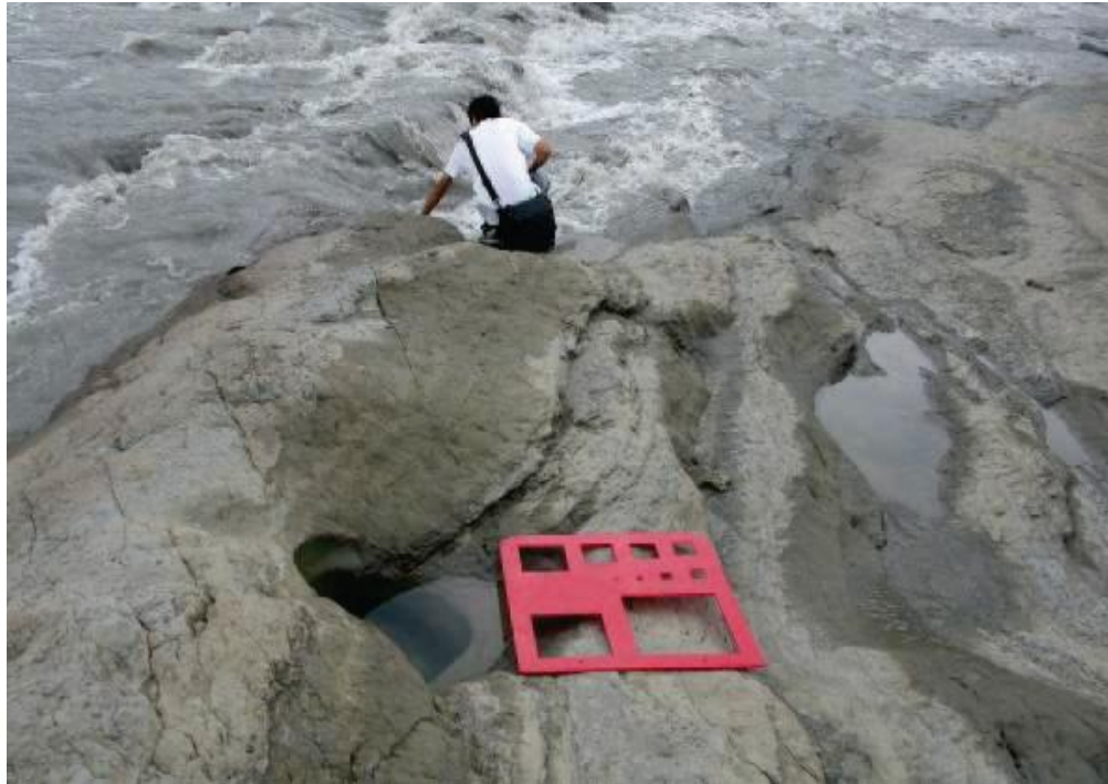
圖 2-7 大安溪水流衝擊或渦流造成的孔洞沖蝕痕跡(經濟部水利署水利規劃試驗所，2009)
