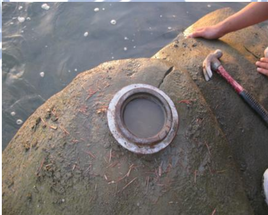
圖 3-2 底座打入軟岩後造成裂縫
