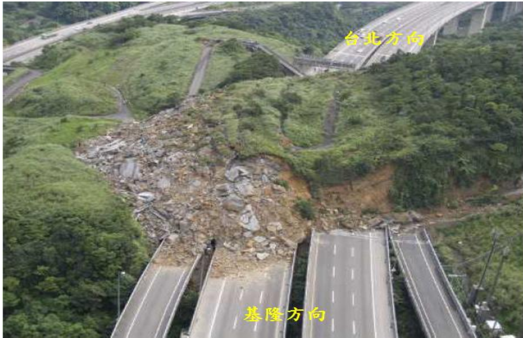
圖 3-24 災害發生現場情形 (摘自國道3號3.1公里崩塌事件原因調查工作總結報告)
