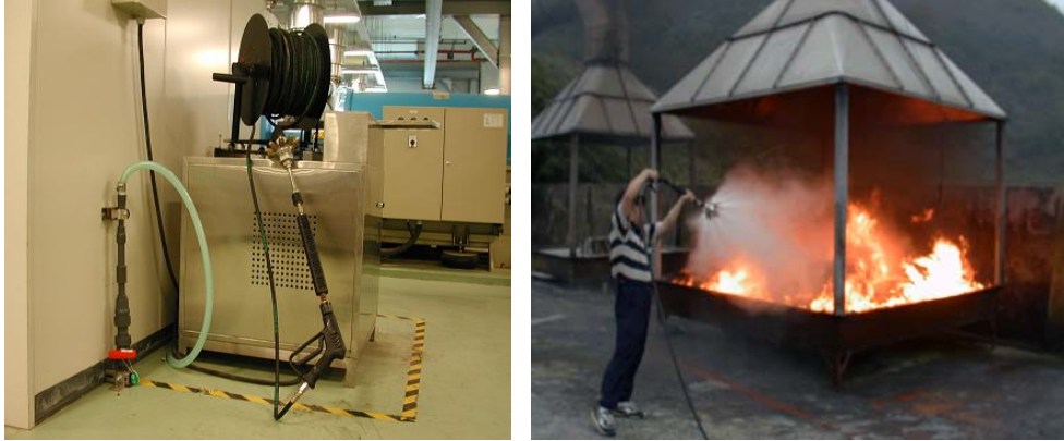
圖 14 移動式細水霧滅火設備
