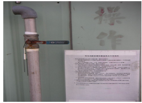
圖 20、緊急遮斷操作裝置
