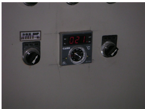
圖 45、儲槽自動灑水控制箱
