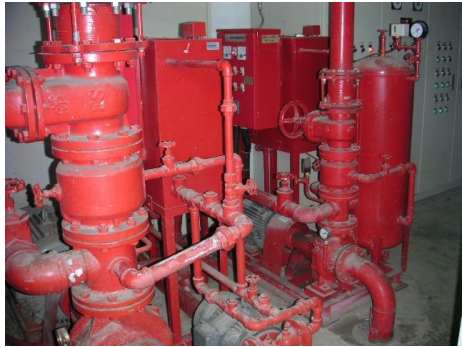
圖 43、手動及自動加壓消防泵浦
