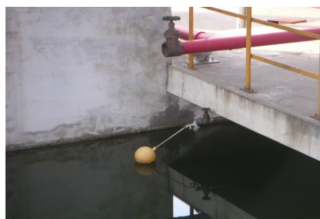
圖 34 儲槽區消防及灑水用水池（浮球開關—水量充足水面達規定量且無髒污
