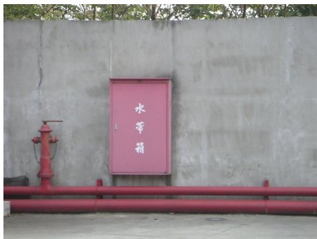
圖 39、消防設備—消防栓、消防箱及消防管—儲槽 40 m 內以儲槽表面積每 50m 2 設 1 個消防栓
