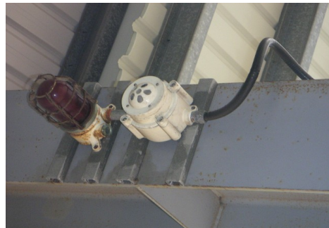
圖 28、危險場所設置之電器防爆構造—警示燈及警報裝置
