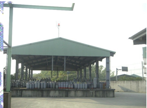
圖 38、殘氣容器儲存場
