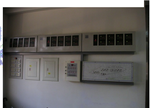
圖 48、分裝場辦公室內設置可燃性氣體洩洩警報裝置
