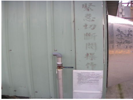
圖 19、緊急遮斷閥操作位置標示
