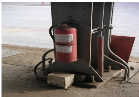
圖 27、處理、儲存 LPG 之場所設置足夠的乾粉滅火器及可燃性氣體偵測器情況
