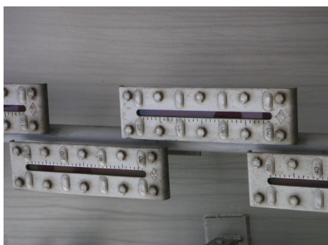
圖 17、儲槽液位計標示最高及最低儲存容量液位情況
