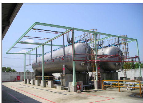
圖 61、儲槽區設置防撞措施，以及儲槽設溫控和手控灑水裝置情況
