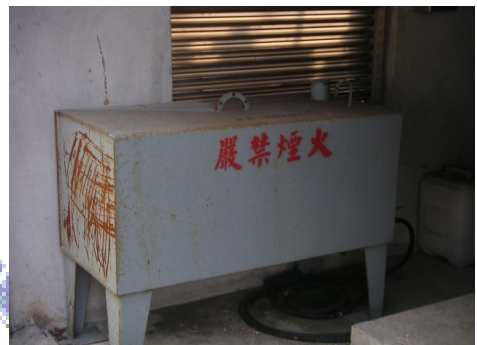
圖 46、發電機房設置緊急發電機用柴油桶
