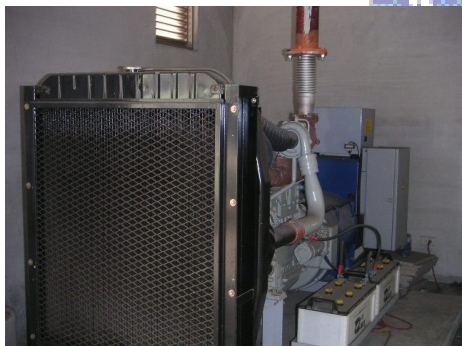
圖 47、發電機房設置緊急發電機組
