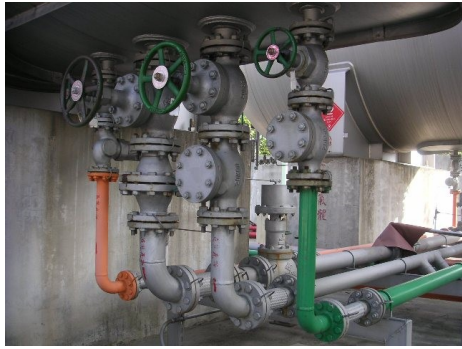
圖 11、管路安全閥及儀錶
