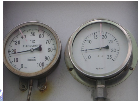
圖 14、儲槽本體壓力錶及溫度計標示最高使用壓力及最高使用溫度
