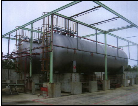
圖 51、地上圓筒型臥式儲槽
