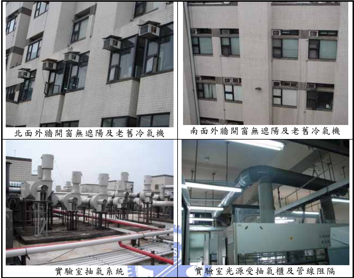
圖 15：科二館外殼及空調設備相片（本研究拍攝）
